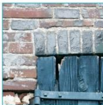
Maillebois : Briques de teinte bleue, flammées.
