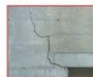
Enduit ciment sur une maçonnerie ancienne : fissurations
