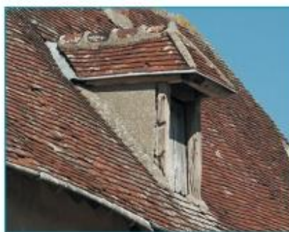
Lucarne sur le versant du toit, charpentée, et à croupe de bordante.
