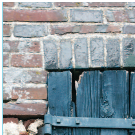
Maillebois : Briques de teinte bleue, flammées.
