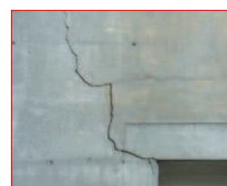
Enduit ciment sur une maçonnerie ancienne : fissurations
