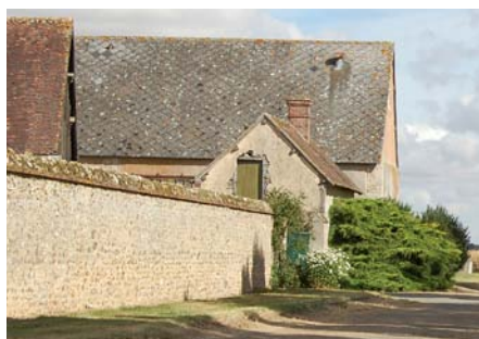
mur de pierres avec couronnement bombé sur un bandeau de briques, reprenant la sobriété de l'ensemble des bâtiments
