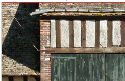
Colombages protégés par un lait de chaux.
