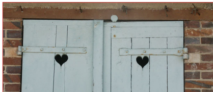
Jour de ventilation en forme de cœur
