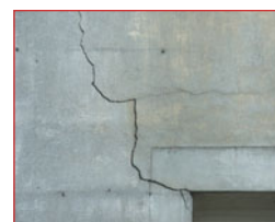
Enduit ciment sur une maçonnerie ancienne : fissurations
