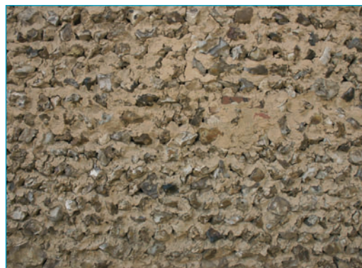
Le soubassement des murs en beuge : rognons de silex et mortier de terre crue. Laons.
