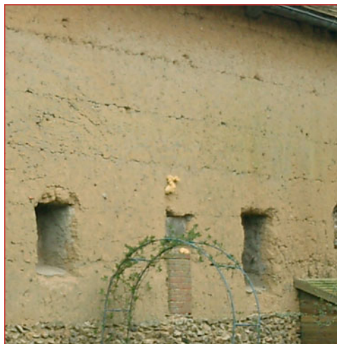
Mur de ferme et en haut à droite mur de clôture en bauge.
