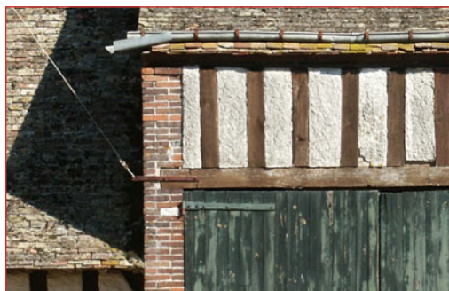
Colombages protégés par un lait de chaux.
