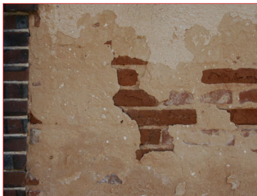
Ancien enduit ocre rouge et brique.
