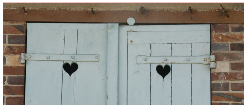
Jour de ventilation en forme de cœur
