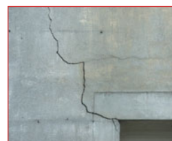
Enduit ciment sur une maçonnerie ancienne : fissurations
