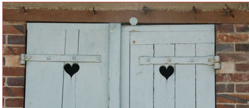
Jour de ventilation en forme de cœur
