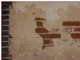
Ancien enduit ocre rouge et brique.
