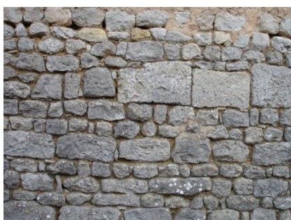
Moellons de calcaire dont le joint a disparu
