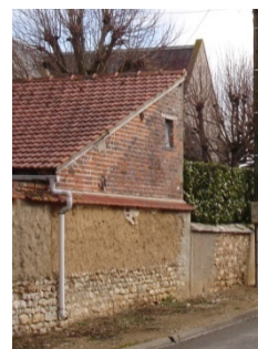
Soubassement en moellons et terre crue. L'enduit de protection à disparu
