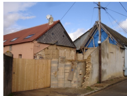
Un exemple de rénovation malheureuse, Boncé
