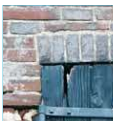
Maillebois : Briques de teinte bleue, flammées.
