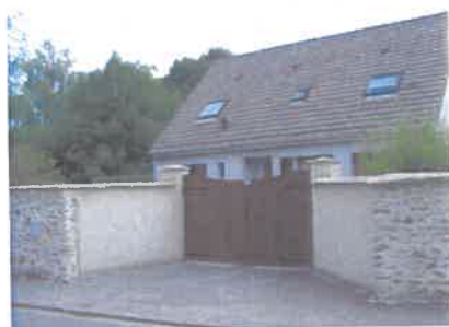
Portail enfoncé, murs enduits
