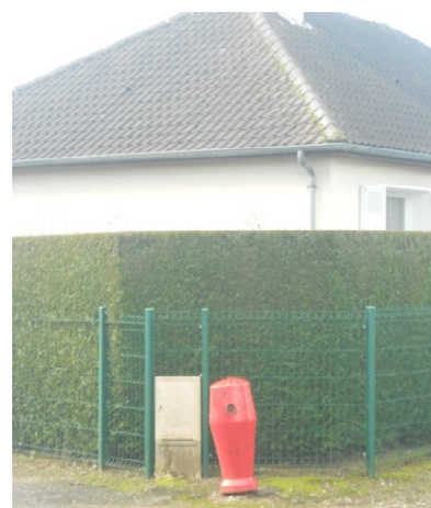
Poteau incendie rue Gustave Flaubert
