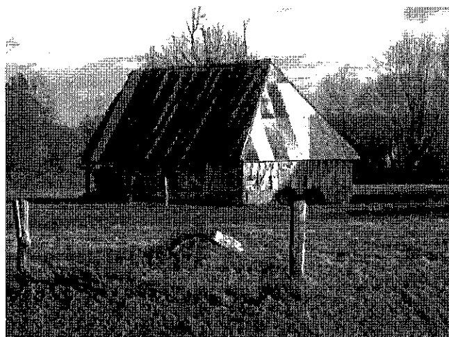
Dégradation d'un bâtiment agricole à la Noé
