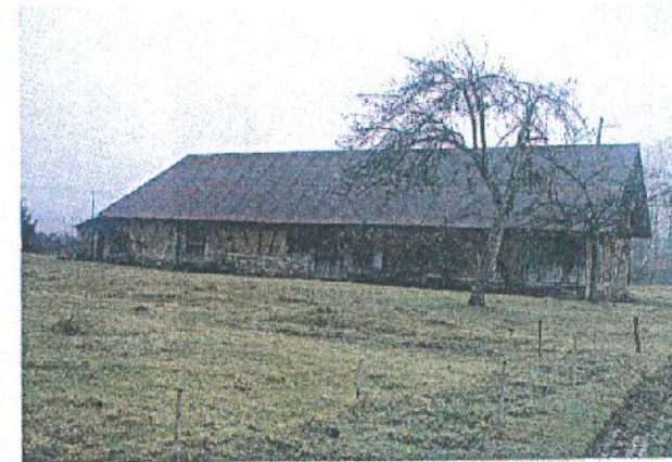
Figure 58 : Bâtiment agricole en torchis vétuste au hameau de la Cauvinière
