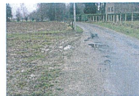
Figure 37 : Terre arable répandue sur la Rue des buissons du fait de l'absence de bande enherbée
