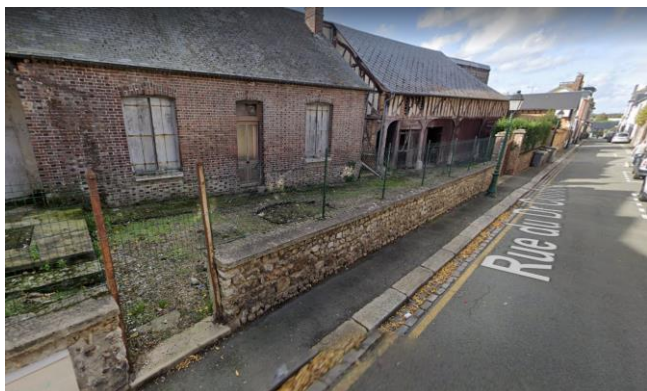
Mur-bahut dégradé (les grilles ont disparu), rue du Dr Couderc (3)
