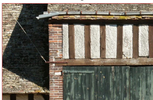
Colombages protégés par un lait de chaux.
