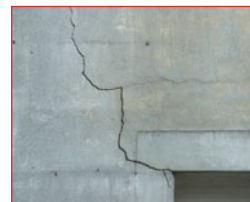
Enduit ciment sur une maçonnerie ancienne : fissurations
