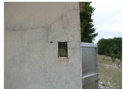
Fissures, ventilation défectueuse
