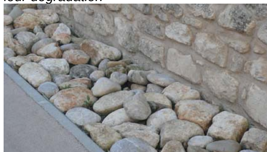
Traitement intéressant d'un pied de mur
