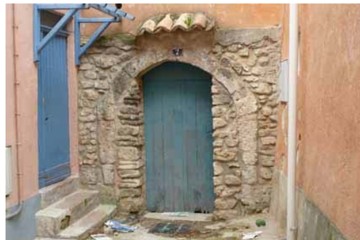
Le retrécissement de l'ouverture est interdit
