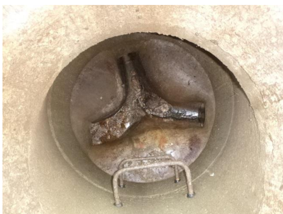
Dépôts – Regard n°24 – Eaux usées
