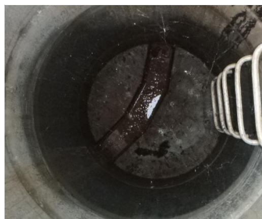
Stagnation d'effluents – Regard n°49 – Eaux usées
