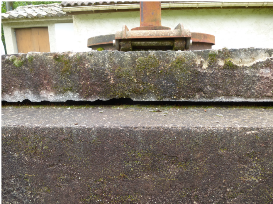
Défaut de recouvrement de la dalle de couverture
