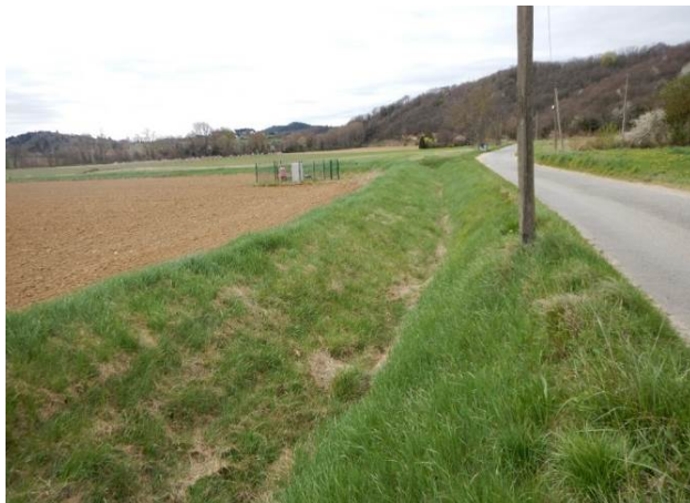
Fossé humide végétalisé en bord de route
