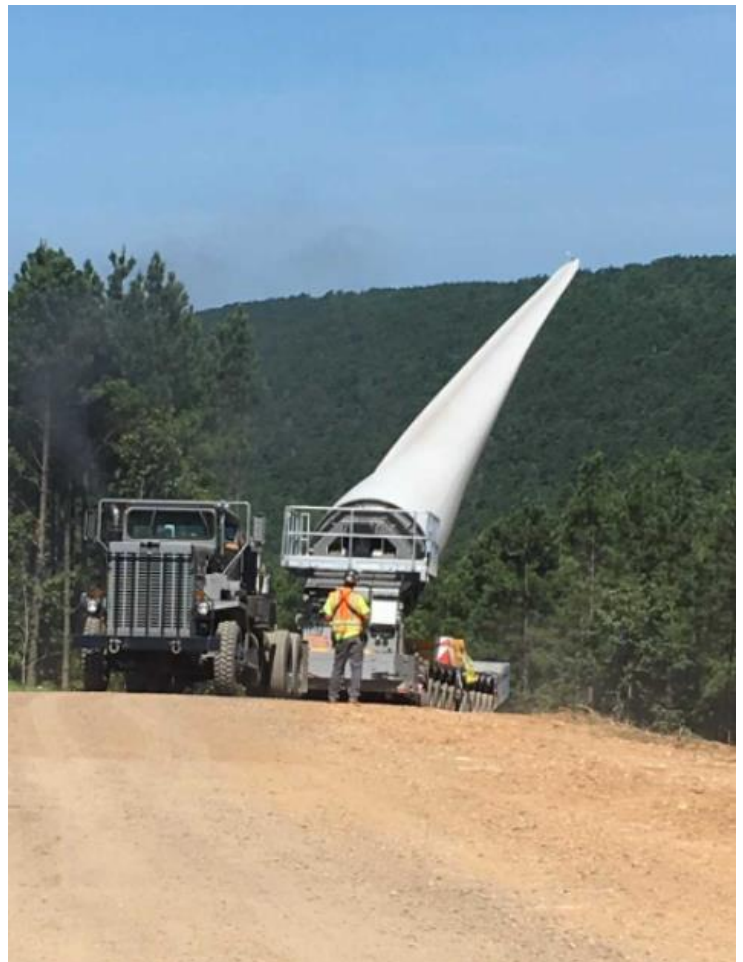
Figure 19 : Utilisation d'un Blade lifter sur un chantier de RES aux Etats-Unis ©RES SAS
