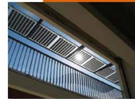
> Capteurs photovoltaïques en brise-soleil
