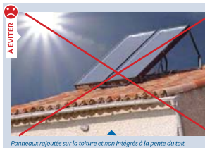
Panneaux rajoutés sur la toiture et non intégrés à la pente du toit
