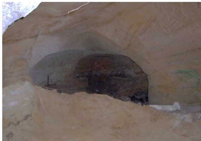
Figure 6 : Cavité n°2 effondrée
