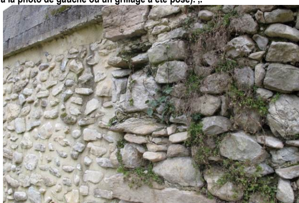
Les interstices des murs en pierres sèches, à conditions que celles-ci n'aient pas été cimentées, permettent l'installation d'espèces animales et végétales.
