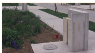
L'intégration des coffrets dans un petit muret construit à l'identique sur l'ensemble de l'opération permet d'en réduire l'impact.
