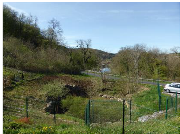
Cône d'effondrement au-dessus du tunnel
