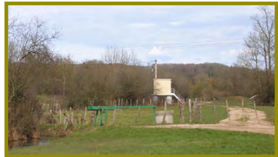
PUITS DE CAPTAGE D'EAU POTABLE DU SIAC
