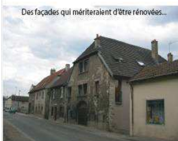
Des façades qui mériteraient d'être rénovées...
