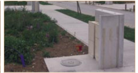
L'intégration des coffrets dans un petit muret construit à l'identique sur l'ensemble de l'opération permet d'en réduire l'impact.
