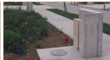
L'intégration des coffrets dans un petit muret construit à l'identique sur l'ensemble de l'opération permet d'en réduire l'impact.
