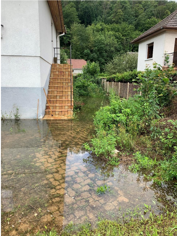
Illustration : le 6 rue de Thulay après un épisode de pluie (photo Ville d'Hérimoncourt, 16 juillet 2021)
