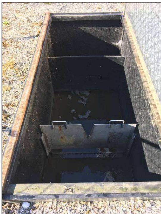
Vue du canal venturi en sortie de STEP
