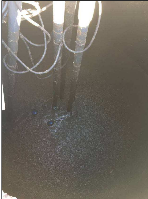
Vue du silo à boue, avec système de pompage pour alimenter les lits de séchage
