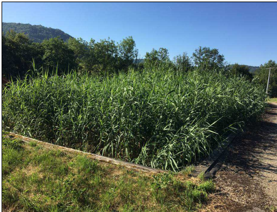
Vue des lits de séchage végétalisés pour boue secondaire
