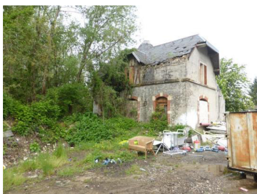
Maison en ruine et déchets éparpillés sur le site
