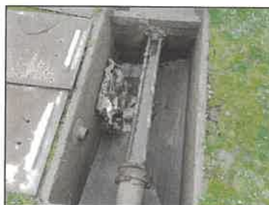
Photo 10 : Déversoir d'orage n°2 en entrée de station de l'APSAH
