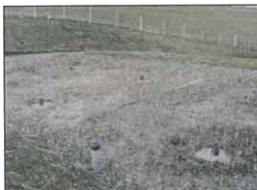
Photo 18 : Filtre de second étage
