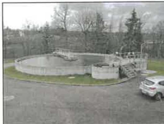
Photo 6 : Clarificateur et pose de reprise des boues
