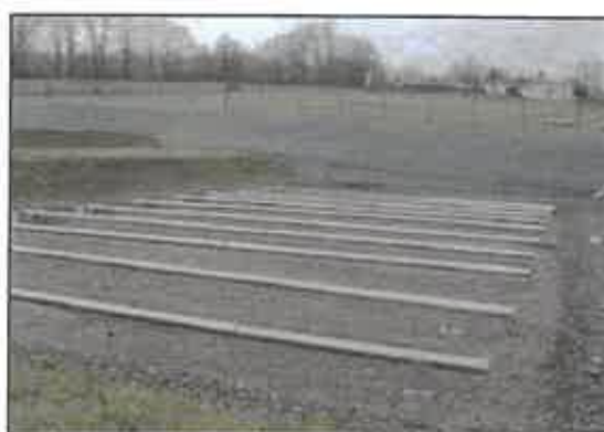
Photo 30 : Filtre de second étage
