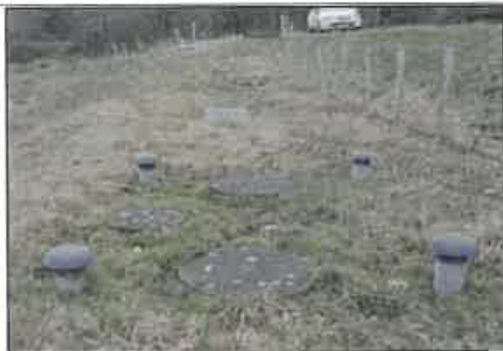
Photo 47 : Vue d'ensemble de la station d'épuration
