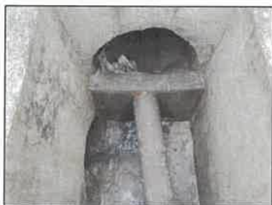
Photo 9 : Déversoir d'orage n°1 en entrée de station de l'APSAH
