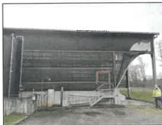
Photo 8 : Silo de stockage des boues
