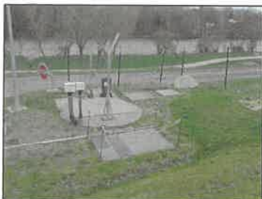
Photo 1 : Poste de relevage d'entrée station
