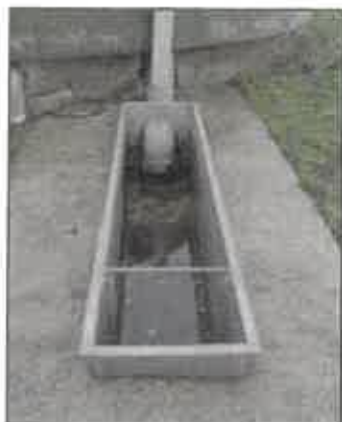
Photo 57: Canal de sortie des eaux traitées
