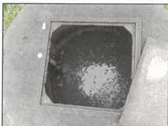
Photo 11 : Regard de refoulement de la station de l'APSAH
