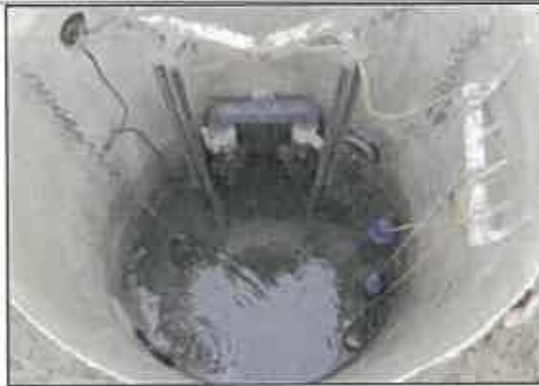
Photo 48 : Poste de refoulement
