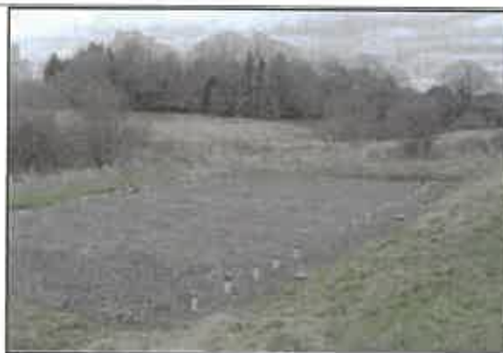
Photo 50 : Filtre à sable
