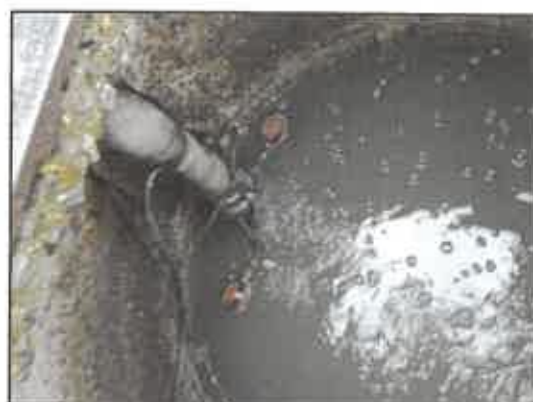
Photo 12 : Fuites et traces de corrosion dans le regard de refoulement
