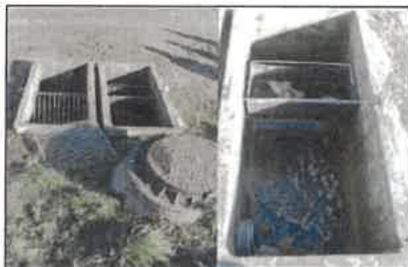
Photo 37 : Dégrilleur en entrée de station d'épuration
