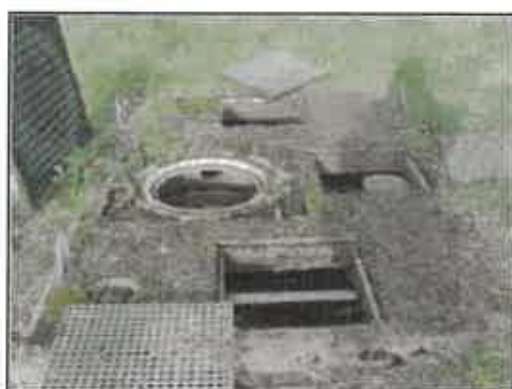
Photo 21 : Vue d'ensemble des lagune
