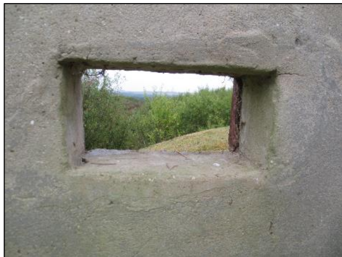
16. Aération dépourvue de moustiquaire. Entrée possible d'animaux dans la cuve
