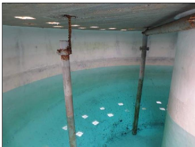
23. Canalisations de trop-plein et de refoulement
