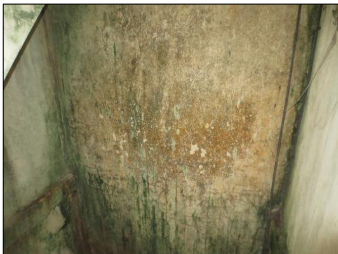
9. Pièce à fort taux d'humidité, les murs sont recouverts de vert
