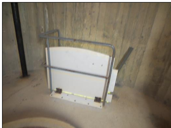
21. 1 er palier : trappe anti-chute
