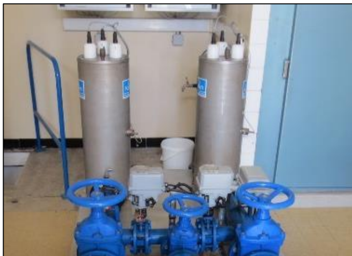
7. Traitement par lampes UV hors service
