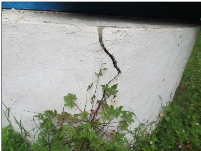
7. Fissure importante dans la maçonnerie de la tête de puits
