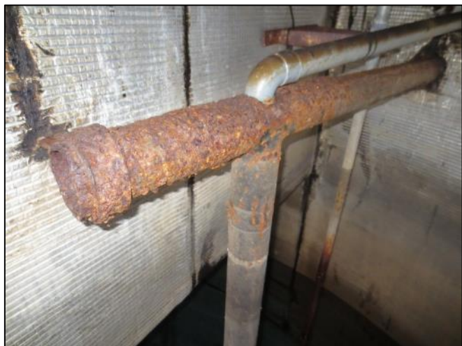
28. Evacuation des eaux de pluie du dôme par le trop-plein (non conforme)
