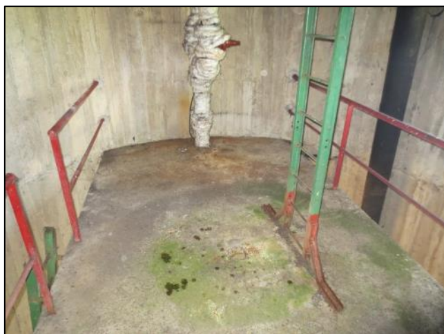
18. 2 nd palier : absence de plinthe et de portillon anti chute
