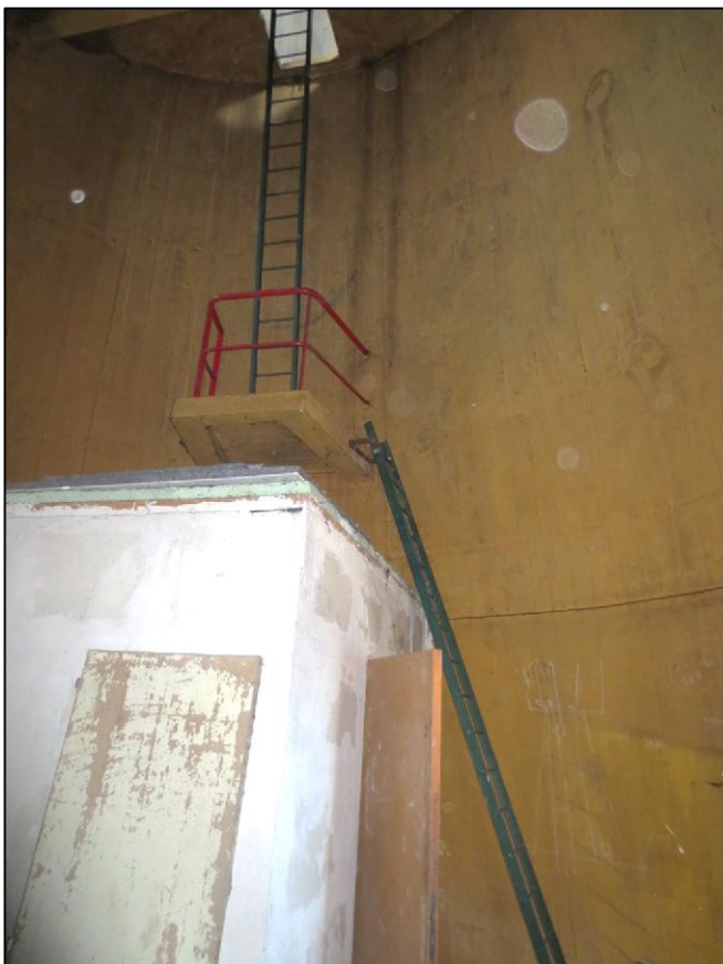
14. Echelles d'accès au 1 er palier. Absence de crinoline, garde corps dépourvu de plinthe, absence de portillon
