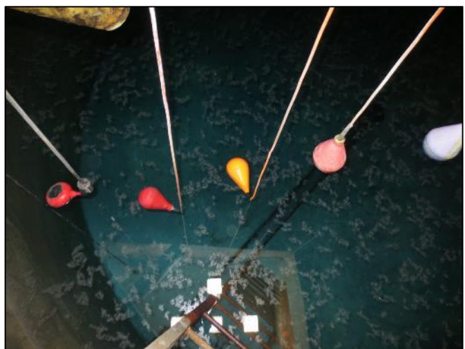
10. Cuve de gauche : poires et capteur piézo de niveau d'eau
