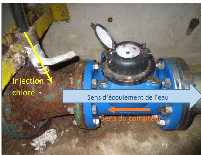
11. Injection de la chloration ; compteur général de production (Zenner DN 100) posé à l'envers
