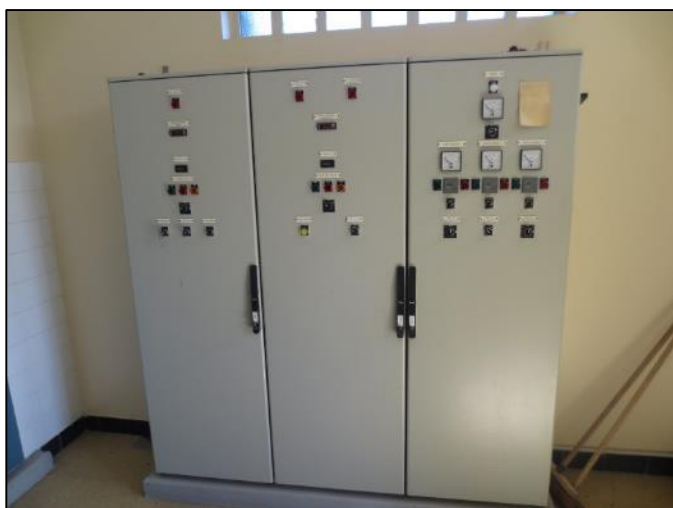
8. Armoire électrique et de commande
