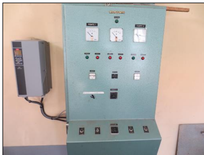
6. Armoire électrique de commande eds pompes et variateur de vitesse Danfoss
