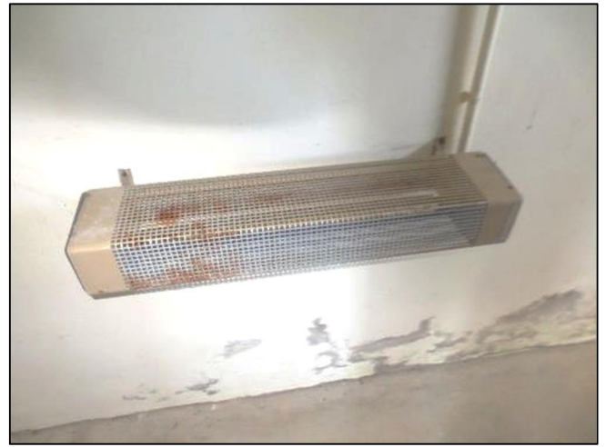
14. Chauffage électrique (hors gel)
