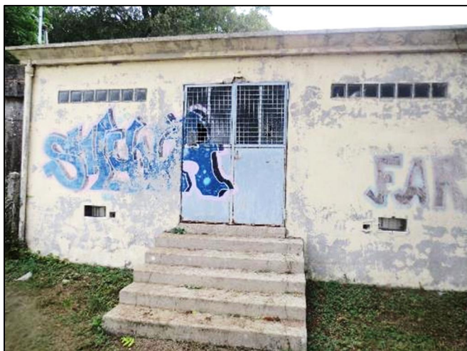
1. Local de vannage. Façade taguée ; Porte en mauvais état
