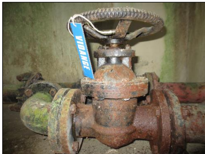
14. Vanne DN 80 sur vidange/trop-plein
