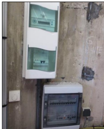
18. Panneau électrique avec disjoncteur et compteur
