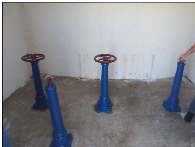
5. Volants de manœuvre des vannes
