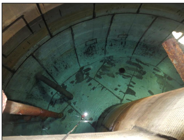
21. Cuve intérieure : revêtement Paxalumin non conforme et détérioré
