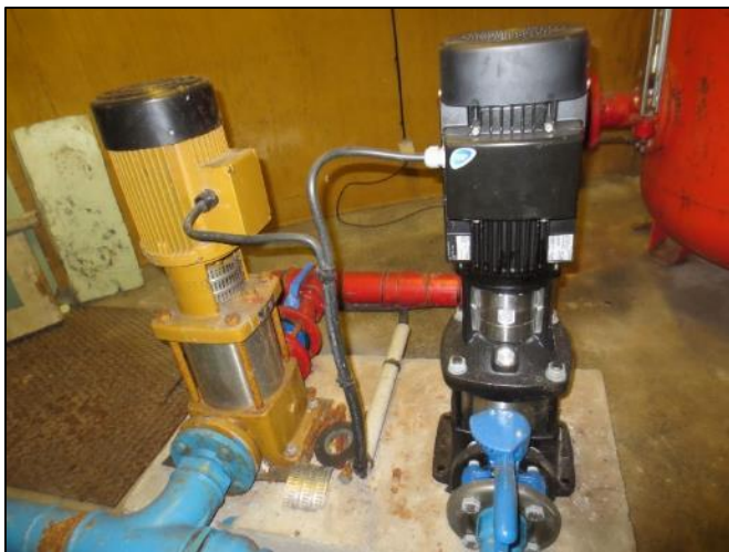
10. Pompes de surpression (2x17m 3 /h)
