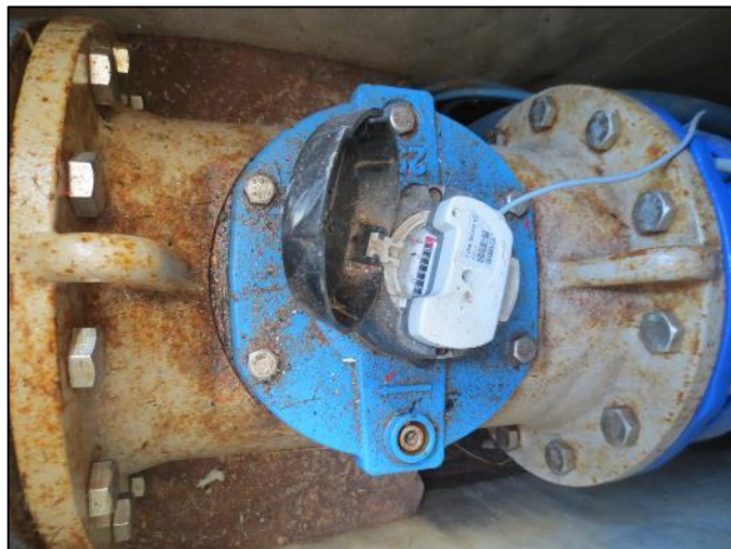
6. Compteur général de production ITRON de 2012 (DN 250)
