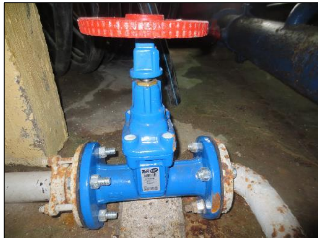
6. Vanne DN 60 sur canalisation de vidange
