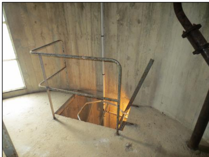
23. 2 nd palier : garde corps dépourvu de plinthe ni de portillon anti-chute
