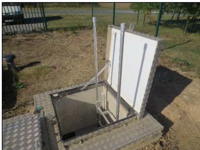
2. Trappe inox d'accès avec dispositif anti intrusion
