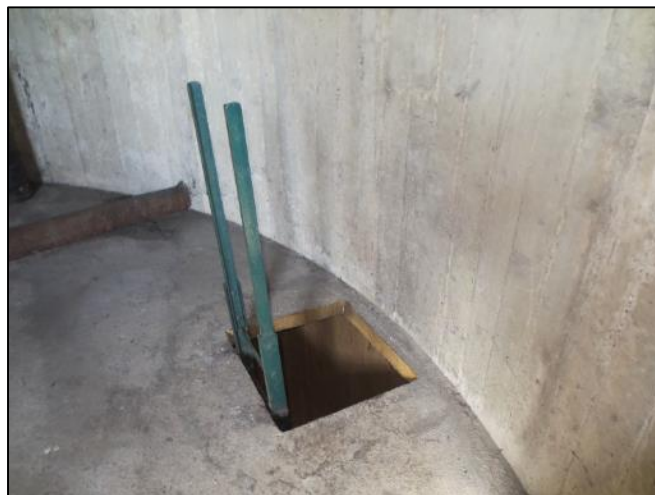
15. 1 er palier : absence de garde corps avec plinthe, absence de portillon automatique
