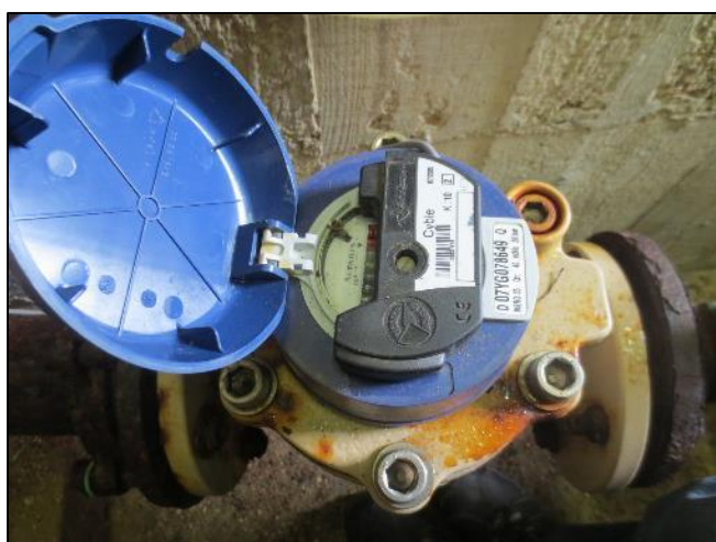
9. Compteur pompe alimentant la cuve d'Héneucourt DN 65 (2007)
