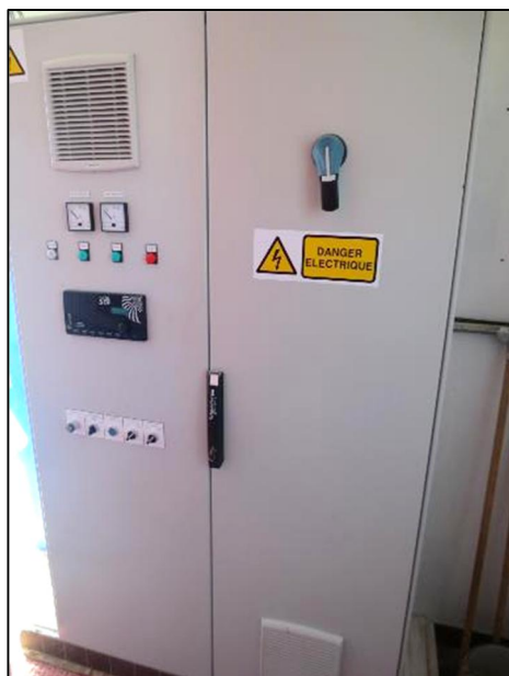
7. Armoire électrique de commande avec SOFREL S550
