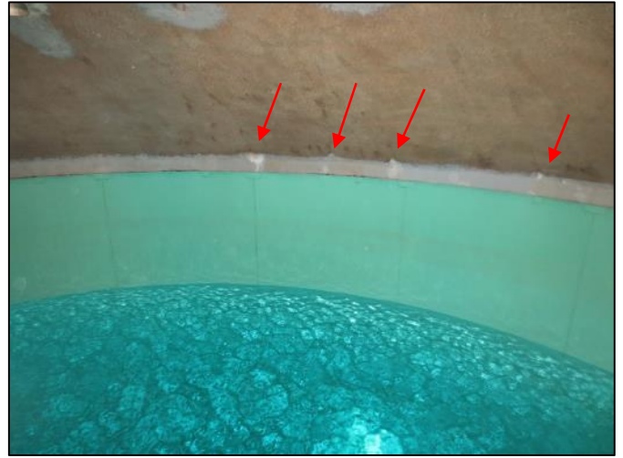
23. Complexe d'étanchéité intérieure en bon état apparent ; Quelques traces d'anciennes fuites à la jonction voile/intrados
