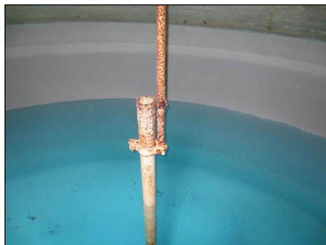
26. Canalisation de trop-plein oxydée
