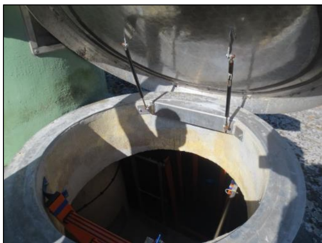
18. Trappe inox d'accès à la cuve
