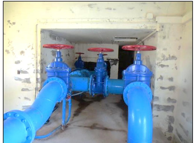
16. Vannage et canalisations de refoulement (Fonte DN 250)
