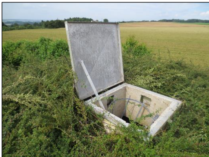
22. Capot étanche et verrouillé d'accès à la cuve de 200 m 3
