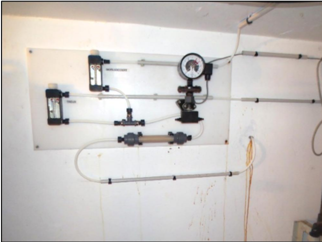
15. Dispositif de chloration (débitmètres, filtre dessicant et vacuostat)
