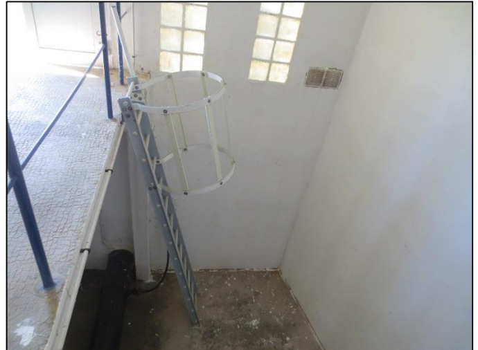
18. Echelle d'accès au vannage (niveau N-1)
