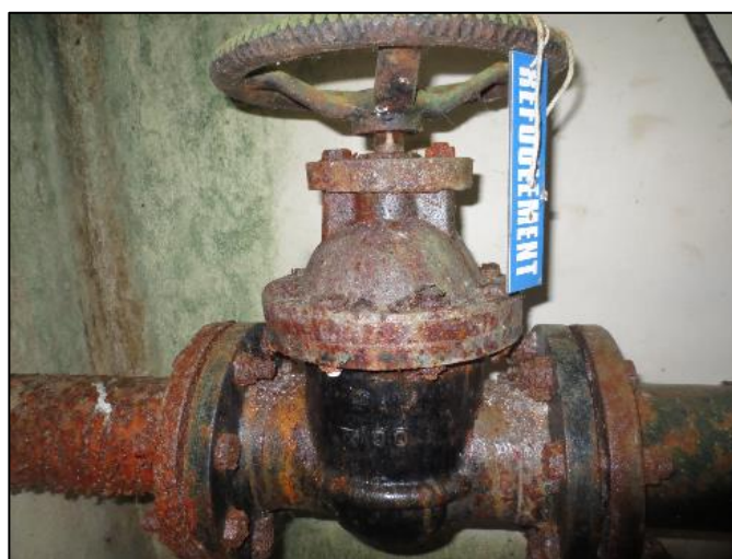
12. Vanne DN 100 sur refoulement
