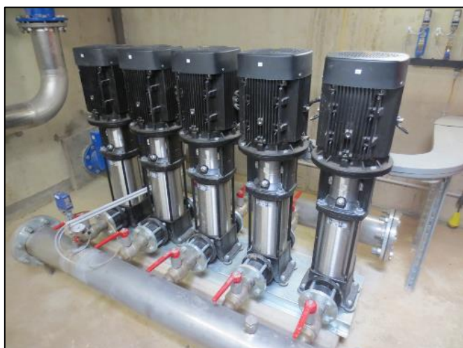
3. Pompes de surpression Grundfos (5x21 m 3 /h)
