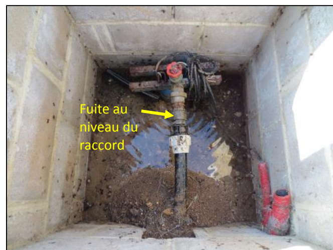
6. Vanne sur colonne d'exhaure
