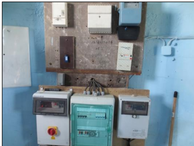
18. Panneau électrique, compteur et disjoncteur électrique
