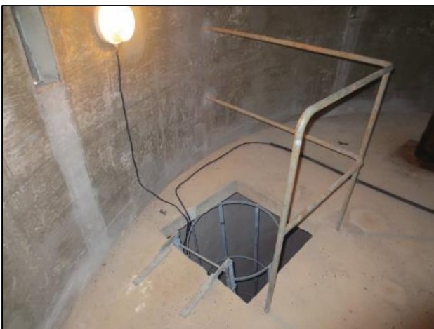
9. Pallier : garde-corps sans plinthe ni portillon automatique anti chute
