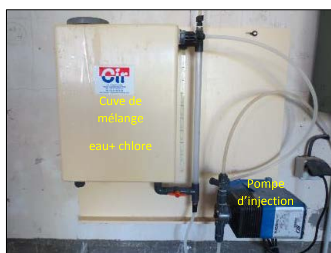
11. Dispositif de traitement – Pompe d'injection CIR
