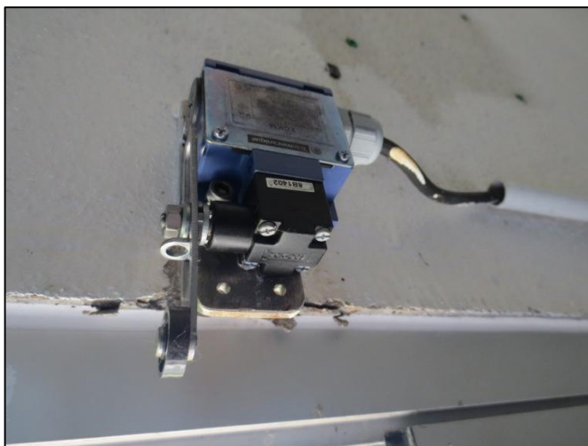
6. Dispositif anti-intrusion de la porte d'entrée
