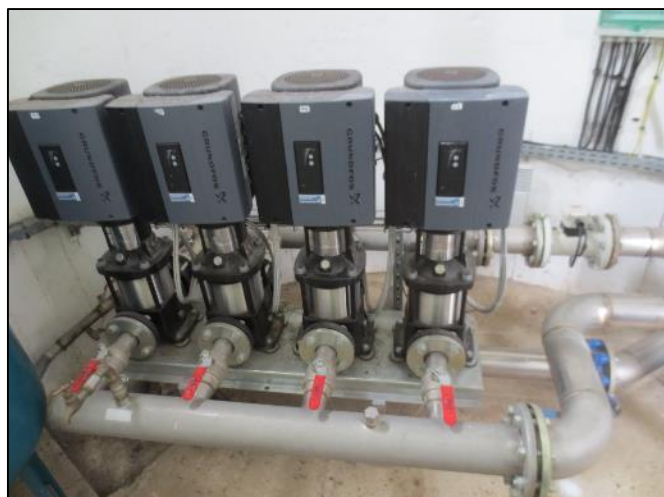
9. Pompes de surpression Grundfos (4x21m 3 /h)
