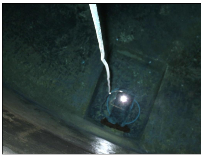
11. Cuve de droite : capteur piézo de niveau
