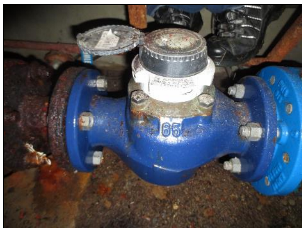
14. Compteur général de production (DN65)
