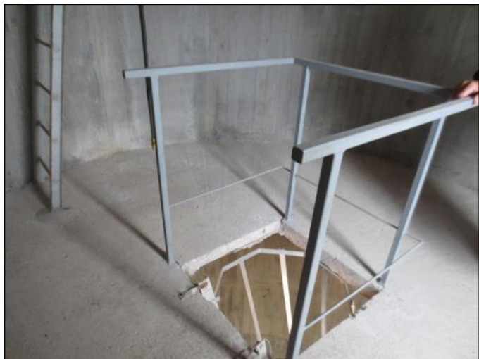
12. 1 er palier : garde-corps sans plinthe ni portillon anti-chute
