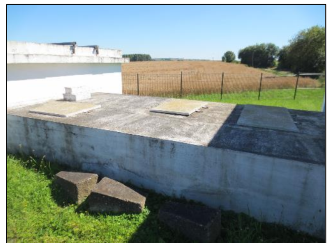
18. Trappe d'accès à la tête de puits pour extraction des pompes
