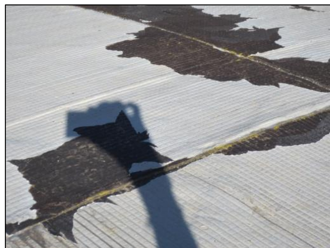
31. Revêtement (Paxalumin) extérieur du dôme fortement dégradé
