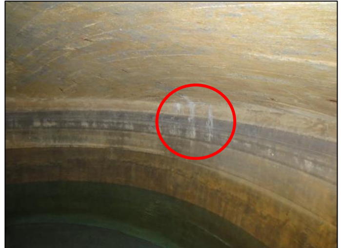
21. Intrados en bon état apparent ; quelques traces de fuites à la jonction voile/intrados
