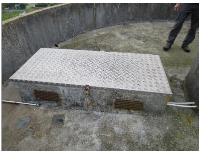
18. Capot Inox d'accès à la cuve
