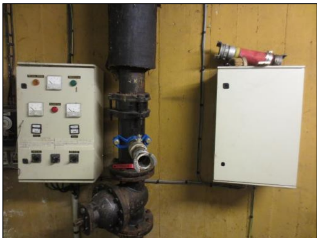
12. Amoire électrique de commande de la surpression
