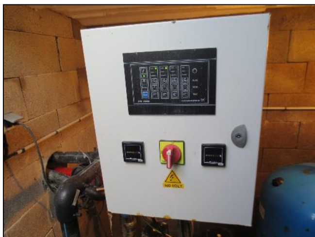
3. Armoire électrique et de commande
