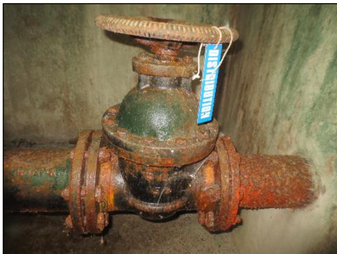
13. Vanne DN 150 sur refoulement
