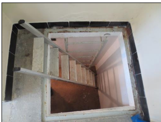
10. Echelle d'accès à la tête de puits (niveau N-1)
