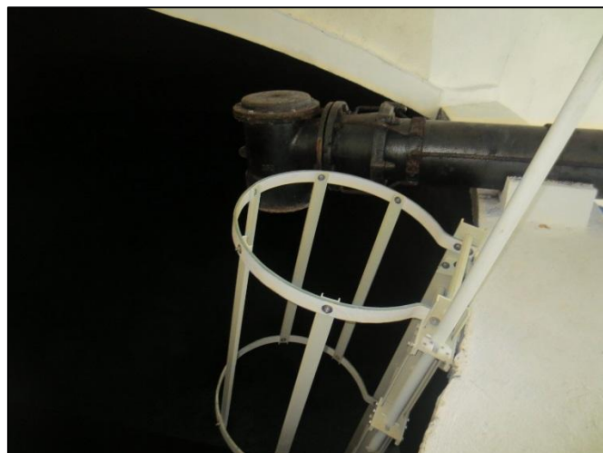
9. Cuve droite : échelle d'accès et canalisation d'alimentation
