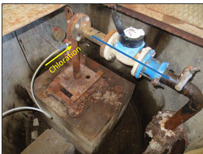
8. Tête de puits protégée par une maçonnerie en parpaings ; point d'injection du chlore
