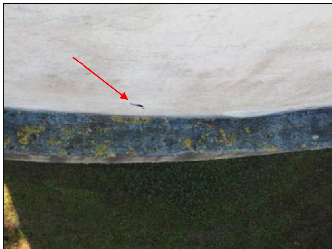
16. Décollement localisé du revêtement extérieur du voile
