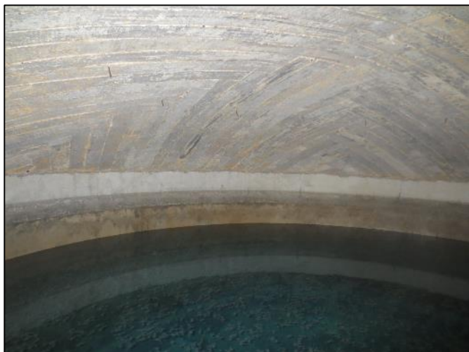
11. Cuve de gauche : Voile de cuve et intrados en bon état apparent
