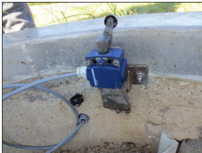
8. Dispositif anti-intrusion sur le capot de la cuve
