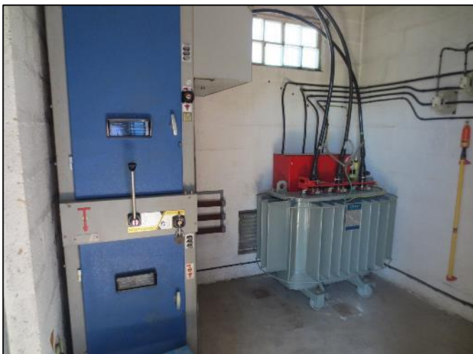
9. Local électrique avec transformateur
