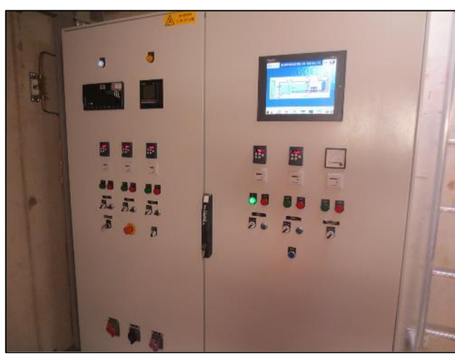
6. Armoire électrique et de commande avec supervision (SOFREL S 550)
