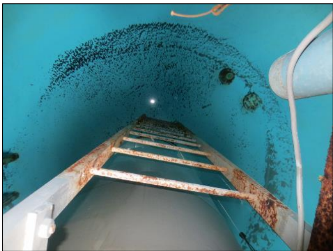
28. Echelle sans crinoline d'accès au fond de cuve
