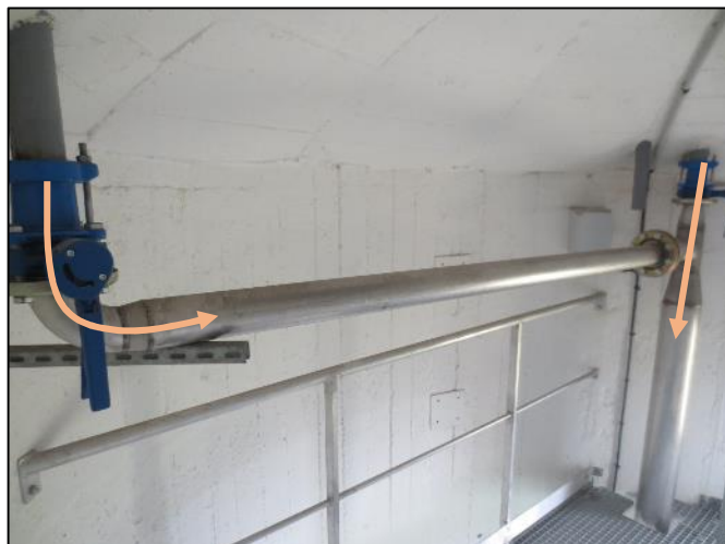
19. Colonne de distribution
