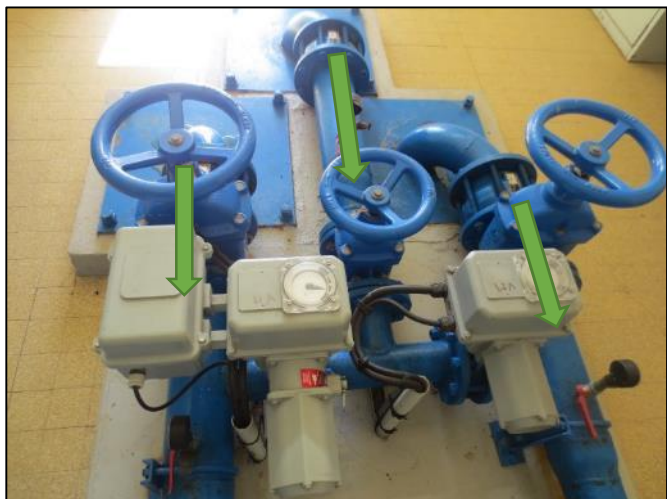
6. Electrovanne sur bypass – vannage sur chaque refoulement
