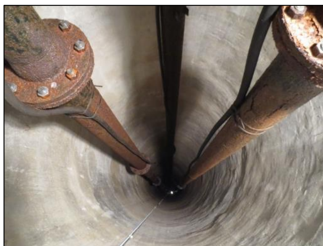
11. Vue intérieure du puits (3 pompes)
