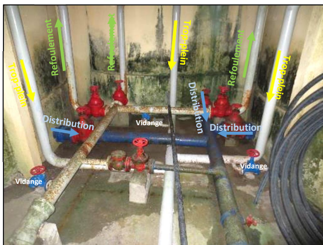
2. Canalisations de refolement, de distribution, de trop-plein/vidange et vannes associées. Canalisations fortement oxydées et murs couverts de mousse
