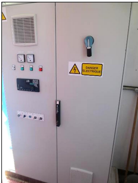
7. Armoire électrique de commande avec SOFREL S550
