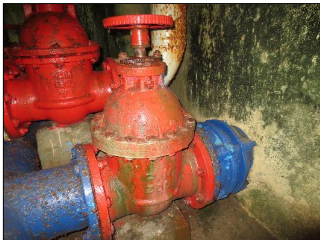
5. Vanne DN 200 sur canalisation de distribution
