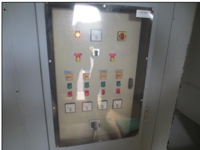
5. Armoire électrique de commande
