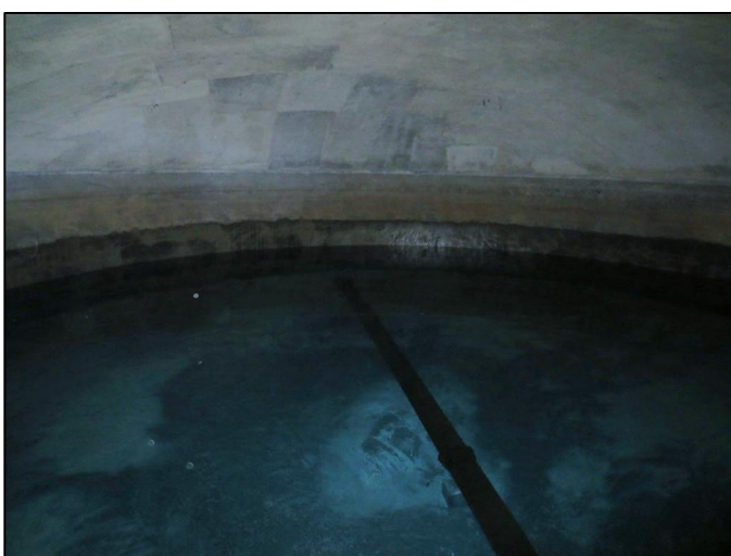
10. Cuve de droite : fond de cuve et canalisation de distribution
