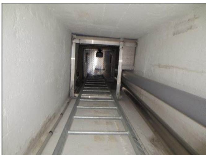
20. Trou d'homme d'accès à la cuve
