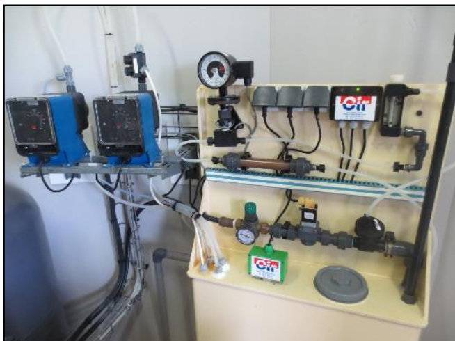
11. Dispositif de chloration CIR
