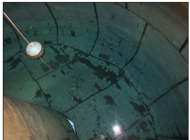
27. Cuve extérieure : paxalumin détérioré
