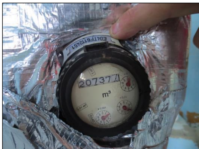
15. Compteur de production du nouveau puits
