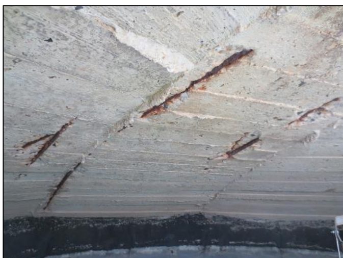
22. Intrados de couple : éclats de béton avec ferrillages apparents
