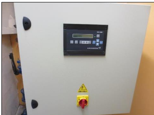
6. Armoire de régulation Grundfos des pompes de surpression
