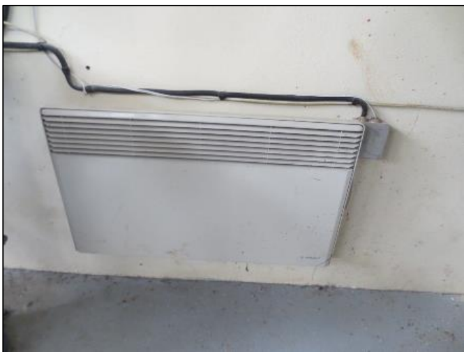
14. Chauffage électrique (pour mise hors gel)
