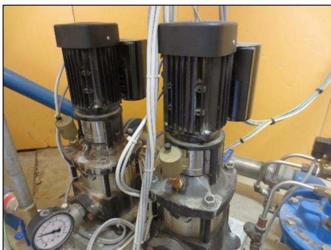
4. Pompes de surpression Grundfos (2x10m 3 /h)
