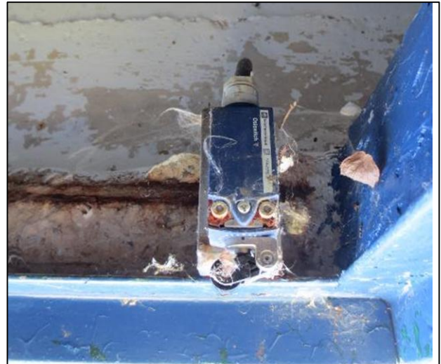
4. Dispositif anti-intrusion sur la porte d'entrée
