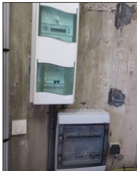
18. Panneau électrique avec disjoncteur et compteur
