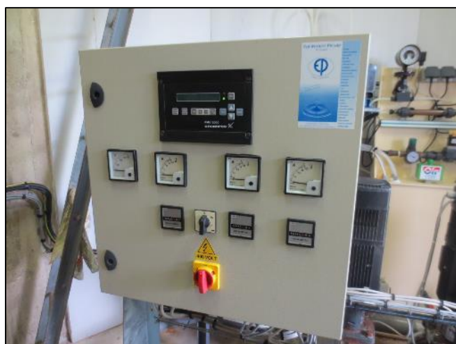
13. Armoire de régulation Grundfos des pompes de surpression
