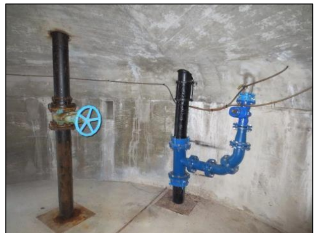
10. Refoulement, vidange et trop plein
