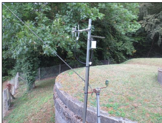
11. Antenne de communication entre le réservoir et le captage (asservissement des pompes)
