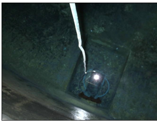
11. Cuve de droite : capteur piézo de niveau
