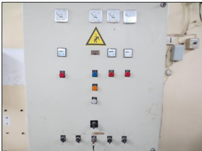
6. Armoire électrique et de commande des pompes
