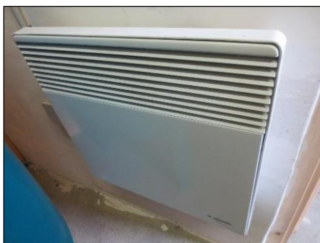
9. Chauffage électrique (hors gel)
