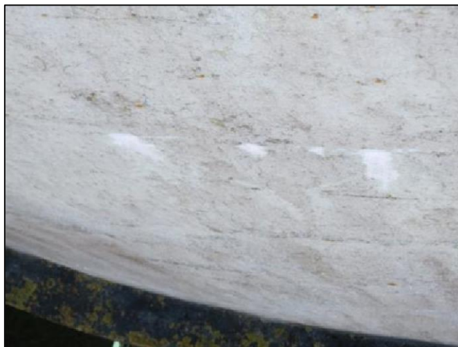
17. Traces de calcite, témoins d'anciennes fuites de la cuve
