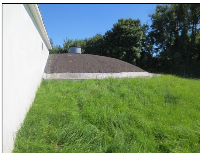
4. Cuve droite : revêtement extérieur paxalumin
