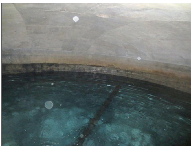
15. Cuve gauche : fond de cuve et canalisation de distribution
