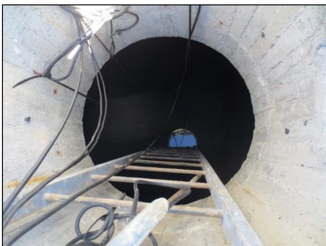
10. Echelle d'accès au fond de cuve dépourvue de crinoline
