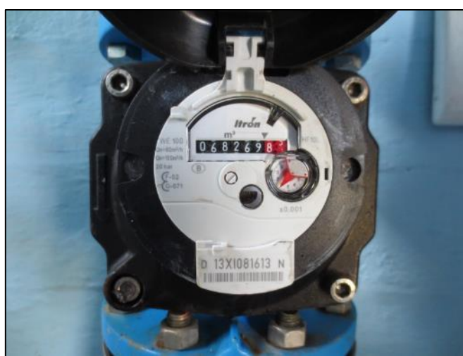
16. Compteur de distribution (sortie de cuve) DN 100
