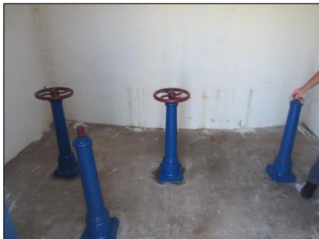
5. Volants de manœuvre des vannes
