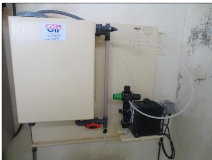
10. Cuve de mélange des réactifs de désinfection et pompe doseuse Grundfos
