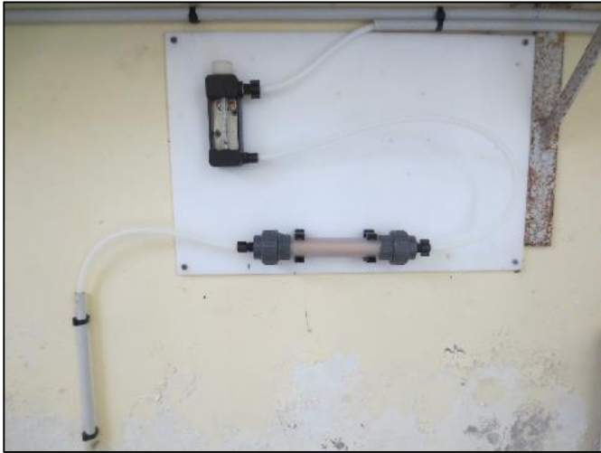
12. Dispositif de chloration (débitmètre, filtre dessicant)
