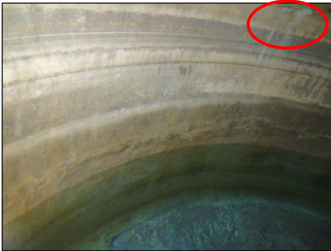
20. Voile de cuve en bon état apparent ; quelques traces de fuites à la jonction voile/intrados
