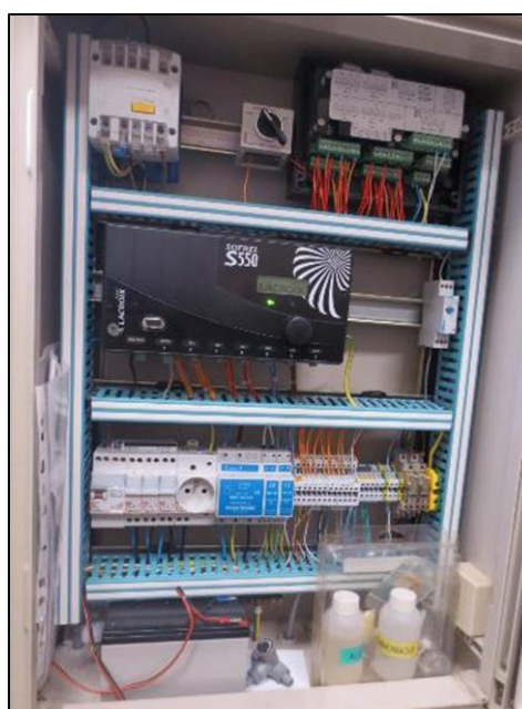
16. Armoire électrique de commande avec télégestion
