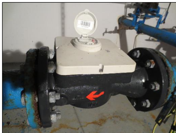
14. Compteur de production Aquila DN 100 (2008)
