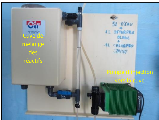
19. Dispositif de chloration
