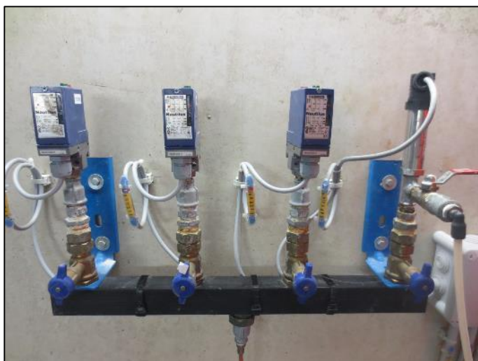
5. Pressostats électromécaniques + sonde pressiométrique
