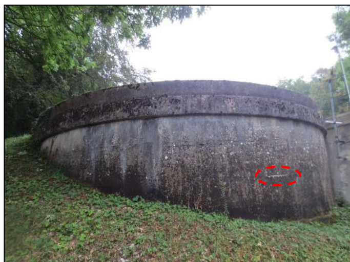
10. Voile extérieur d'une des cuves de 150 m 3 ; trace de calcite témoin d'une probable fuite
