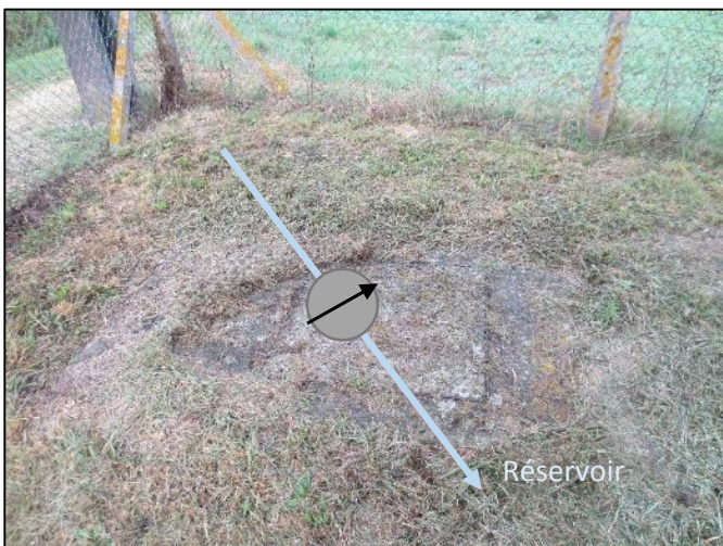
3. Regard pour comptage (non télégréré) des volumes arrivant au réservoir
