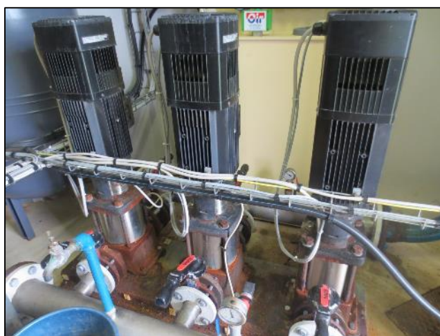
12. Surpression Grundfos (3x16m3/h)
