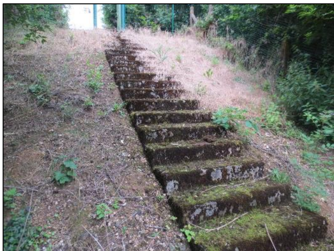
3. Escalier rendu glissant par la mousse et la végétation
