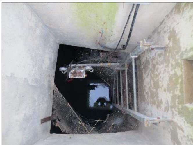
18. Echelle d'accès à la cuve dépourvue de crinoline
