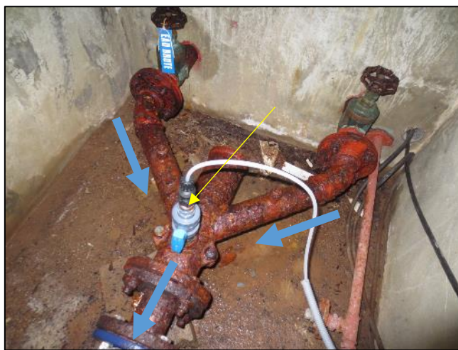
13. Convergence des deux refoulement (un par pompe) ; point d'injection de la chloration (jaune)
