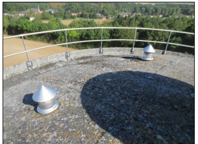
15. Dôme en bon état apparent – cheminées d'aération de la cuve
