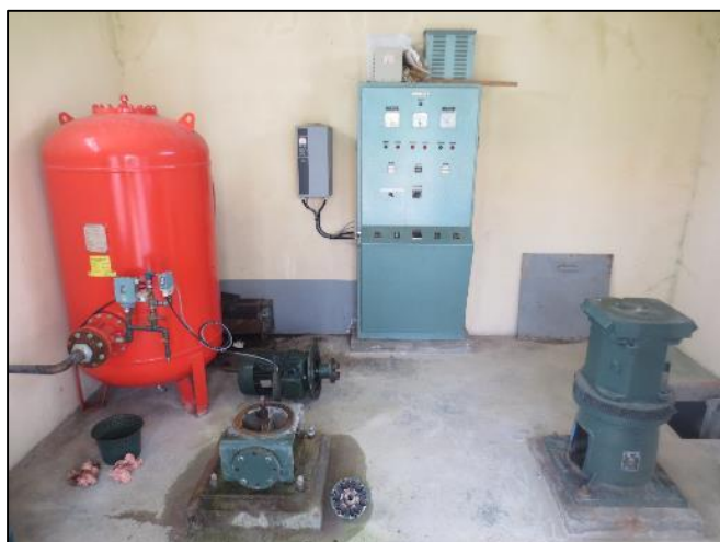
3. Vue générale de l'intérieur du local technique ; Pompe n°1 (à gauche) déposée pour réparation
