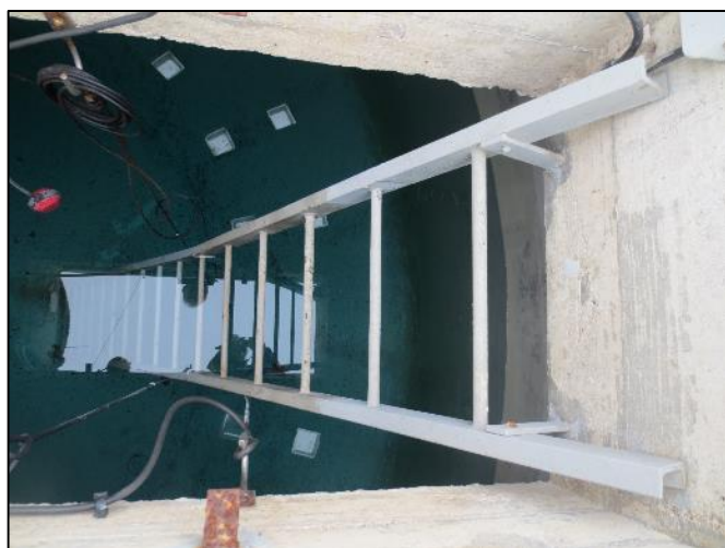
19. Echelle sans crinoline d'accès au fond de cuve
