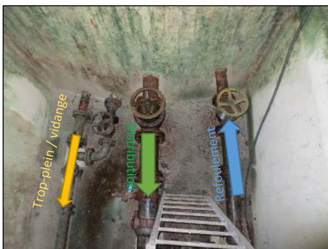
11. Canalisations liées à l'ouvrage et vannage
