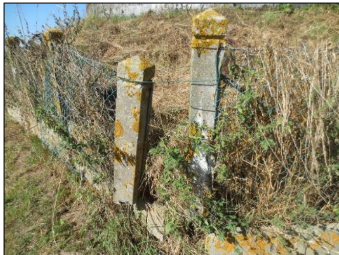
2. Clôture et poteaux béton endommagés
