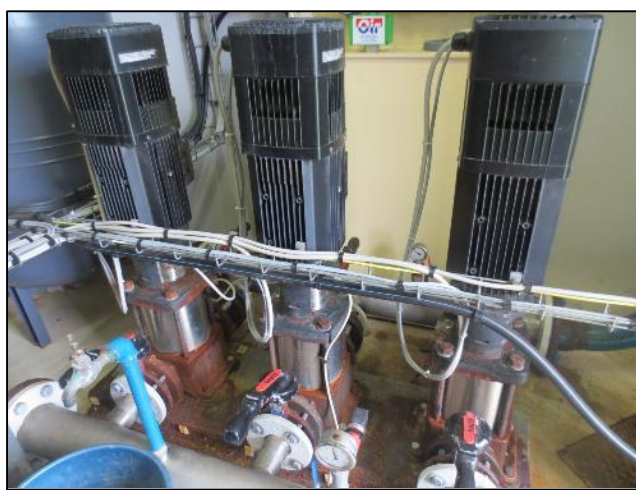
12. Surpression Grundfos (3x16m3/h)
