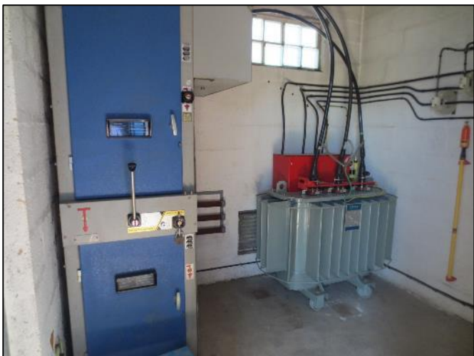
9. Local électrique avec transformateur
