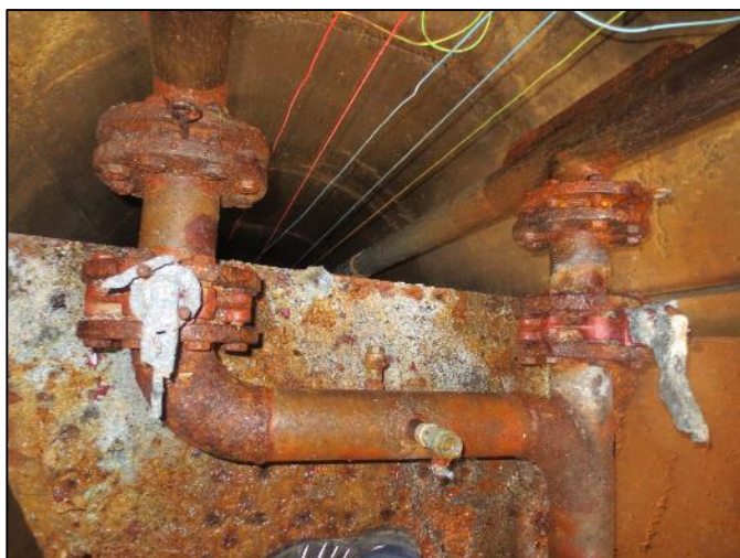
9. Vannage fortement oxydé
