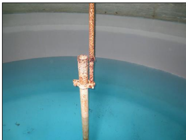
26. Canalisation de trop-plein oxydée
