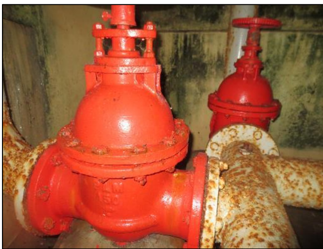
4. Vanne DN 150 sur canalisation de refolement
