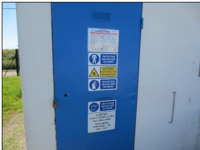
10. Local annexe de chloration avec stockage des bouteilles de chlore gazeux
