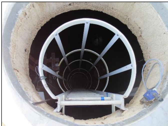
7. Regard et échelle d'accès à la cuve
