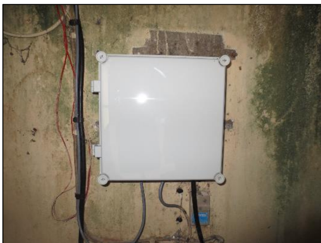
3. Coffret de télégestion (report vers captage par radio)
