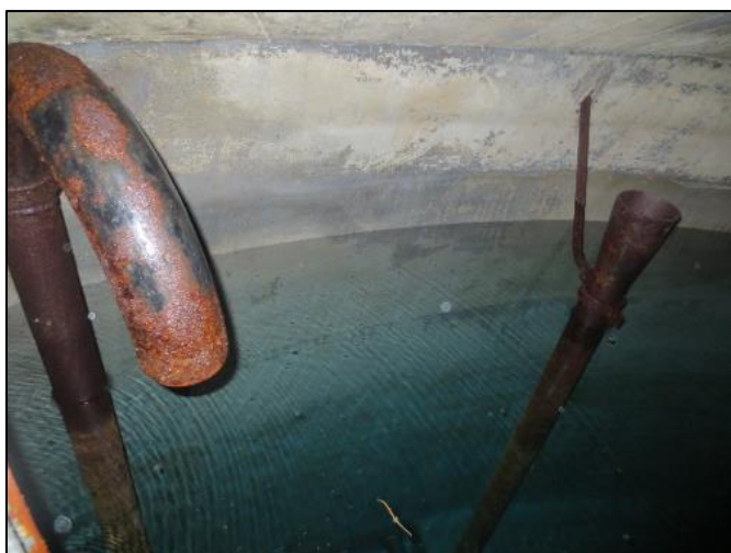
20. Alimentation de la cuve (refoulement) par col de cygne ; canalisation de trop-plein
