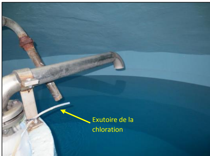
23. Canalisations de refoulement (ancien et nouveau puits) ; Exutoire de la chloration
