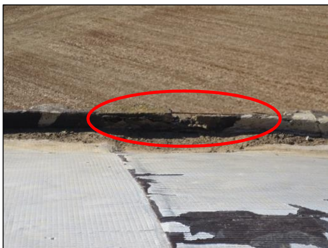
30. Ceinture du dôme : bétons dégradés
