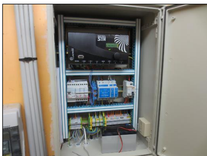
8. Armoire électrique de commande avec télégestion SOFREL S 550
