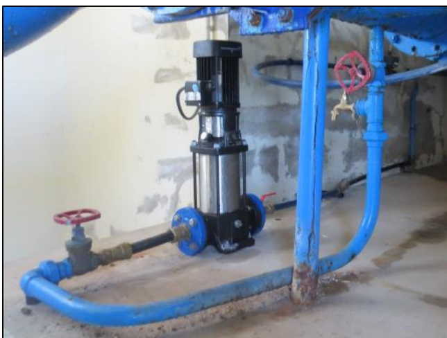
17. Pompe motrice d'eau brute pour chloration (Grundfos)
