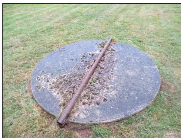
15. Plaque de couverture du puits
