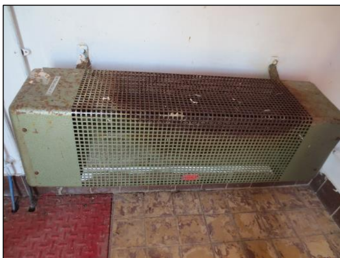
5. Chauffage électrique (hors gel)
