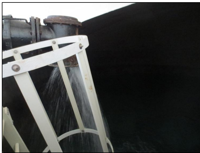
14. Cuve gauche : échelle d'accès et canalisation d'alimentation
