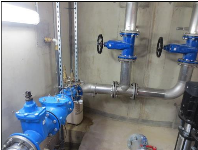
8. Vannes PAM DN 150 + stabilisateur de pression
