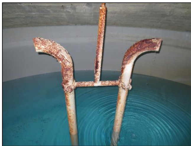
25. Canalisation de refoulement (alimentation de la cuve) oxydée
