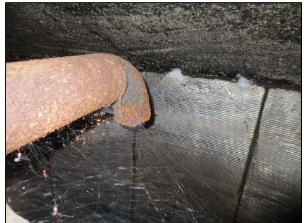
25. Alimentation à gueule bée de la cuve extérieure fortement oxydée
