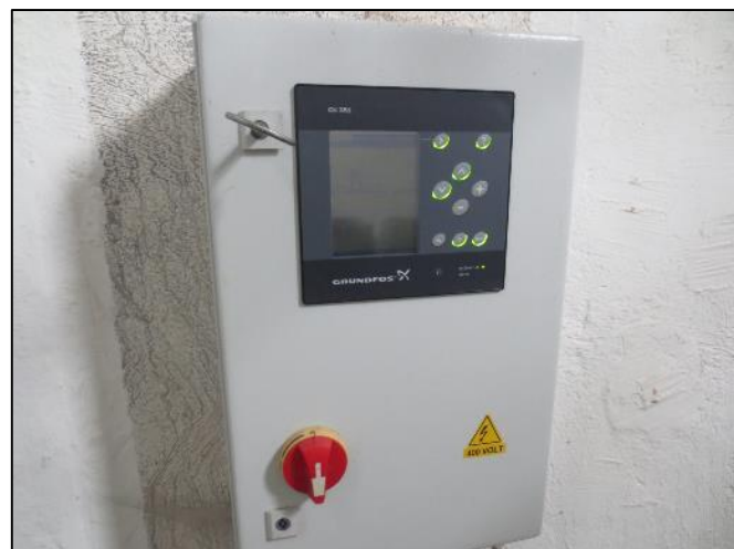
10. Armoire de commande et de contrôle des pompes
