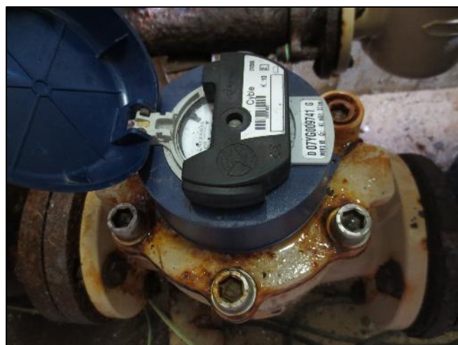
10. Compteur pompe alimentant la cuve de Baizieux DN 65 (2007)
