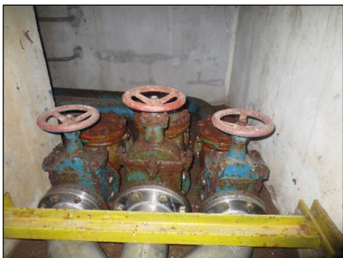
10. Convergence des 3 colonnes de refoulement
