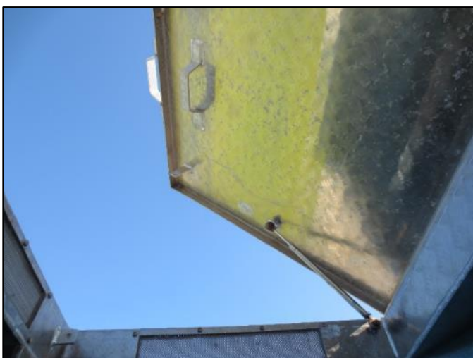
30. Capot d'accès au dôme avec verrins et grilles d'aération
