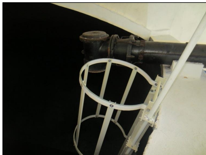
9. Cuve droite : échelle d'accès et canalisation d'alimentation
