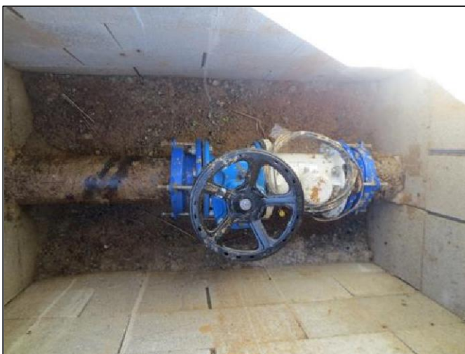
3. Débitmètre de sectorisation nouvellement posé
