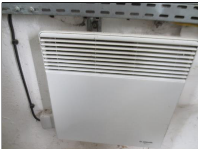
14. Chauffage électrique (mise hors gel)
