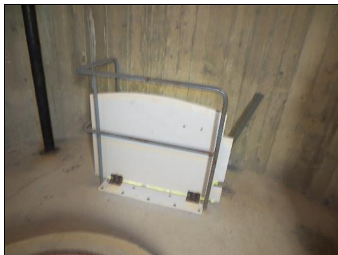
21. 1 er palier : trappe anti-chute
