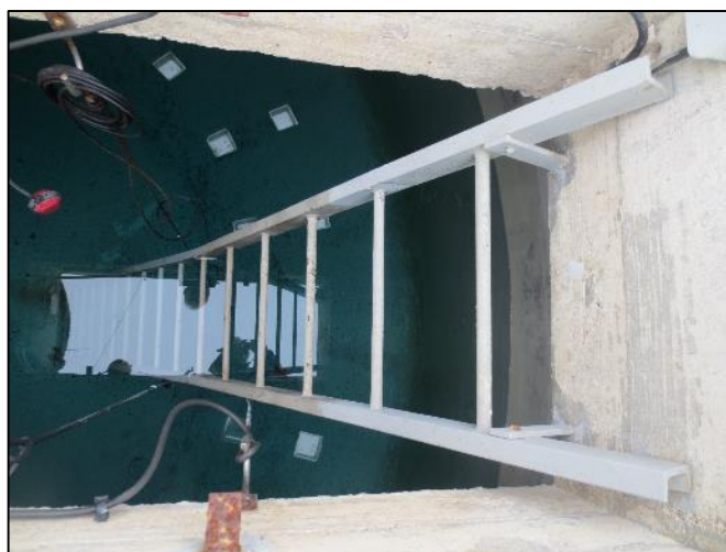
19. Echelle sans crinoline d'accès au fond de cuve
