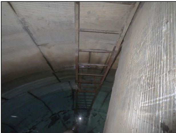
24. Echelle sans crinoline d'accès à la cuve intérieure
