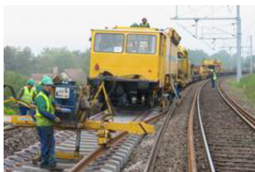
Figure 37: Longs rails soudés sur traverses béton
