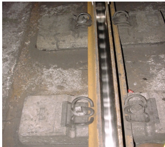
Figure 49: Usure ondulatoire sur une section de rail
