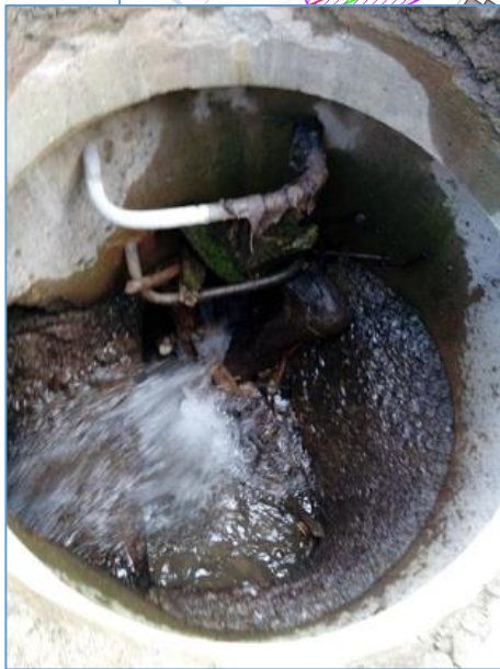
Obstruction du réseau par des embâcles charriés par les torrents collectés
