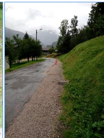
Réseau de drainage le long de la route du Crêt
