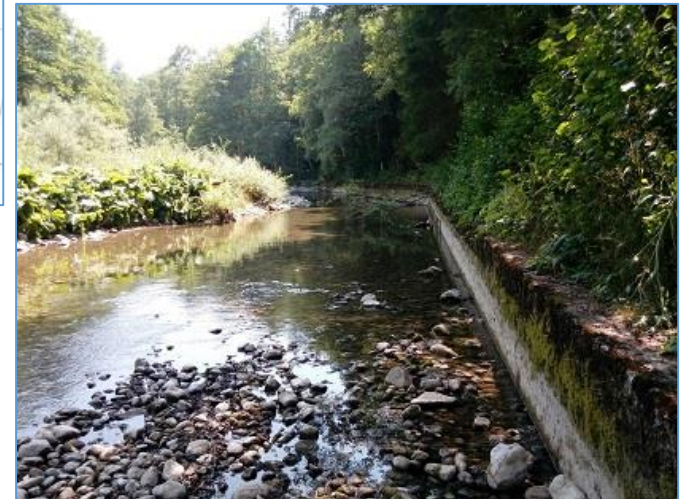
Mur créé en 1982 par le RTM pour lutter contre l'érosion de la berge en rive concave
