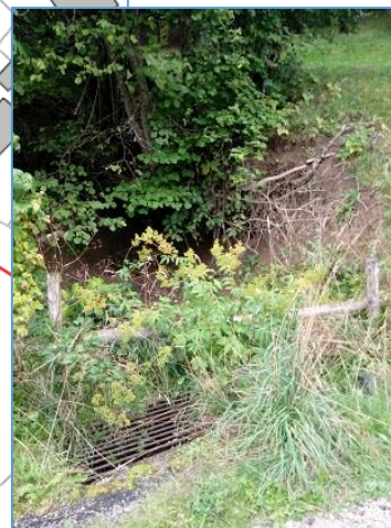
Arrivée d'un ruisseau dans le réseau de drainage
