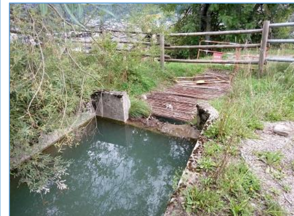
Bac et piège à matériaux en entrée de busage du ruisseau
