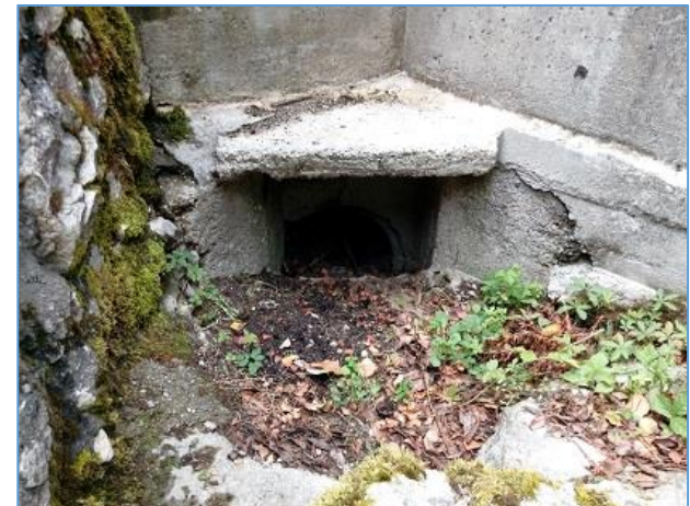
Ouvrage de franchissement obstruant
