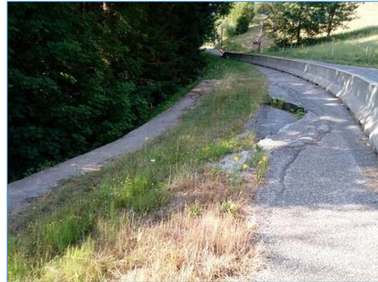
Affaissements et aménagements le long de la RD22
