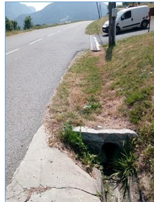
Grille transversale et réseau EP le long de la RD 22
