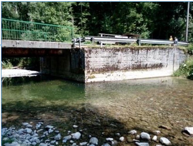
Décalage du pont par rapport à l'axe du torrent
