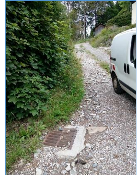
Grille parfois obstruée et débordante au bas du chemin sujet aux ruissellements
