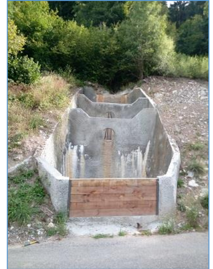
Seuils et bac de rétention sur le ruisseau
