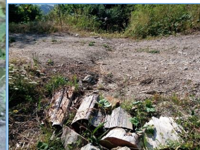
Renvoi d'eau au-dessus du busage
