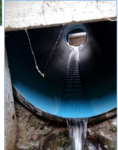
Obstruction du busage du ruisseau
