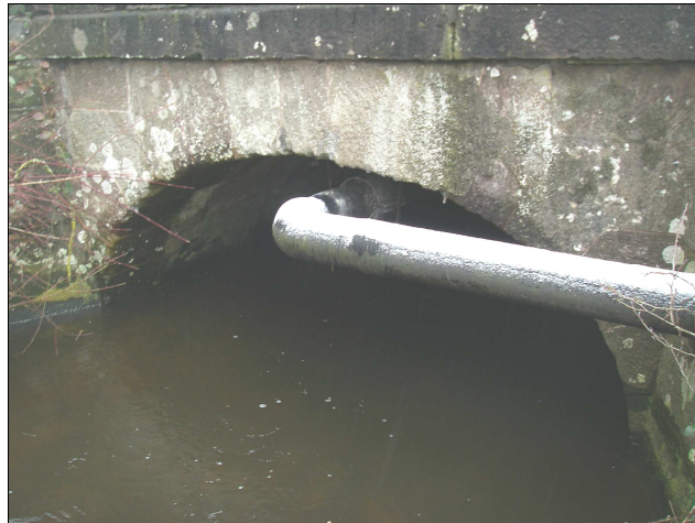
Voûte en pierre du pont de la RN 19 sur le ruisseau Notre-Dame.
