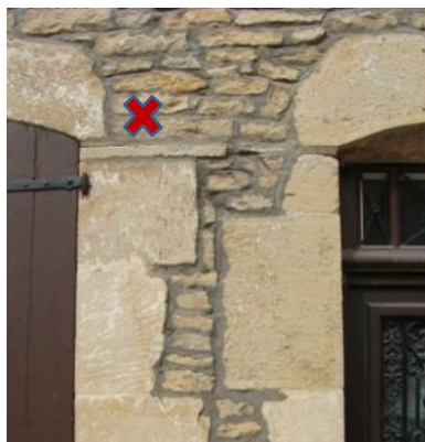
Joints au ciment gris interdits
