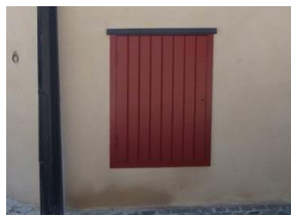
Coffret technique encastré et fermé par un portillon constitué de lames de bois verticales assemblées
