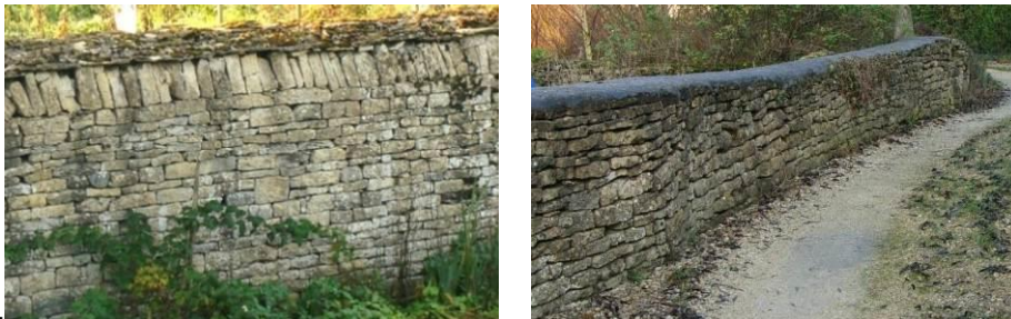
Murs d'assises régulières de pierre calcaire sans joint apparent et couronnement en pierre de lave (gauche) et glacis en mortier (droite)
