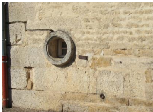
Enduit « à pierre vue » préconisé, exemple du 21, rue de l'Aujon
