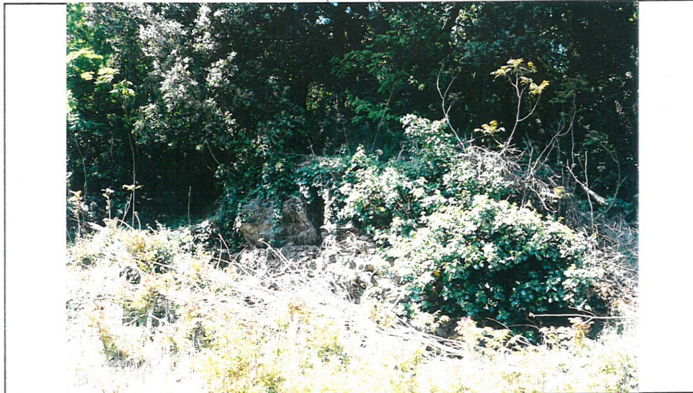
Rue de Maingué - Masse de blocs fracturés instables sur un linéaire de 6 m environ
