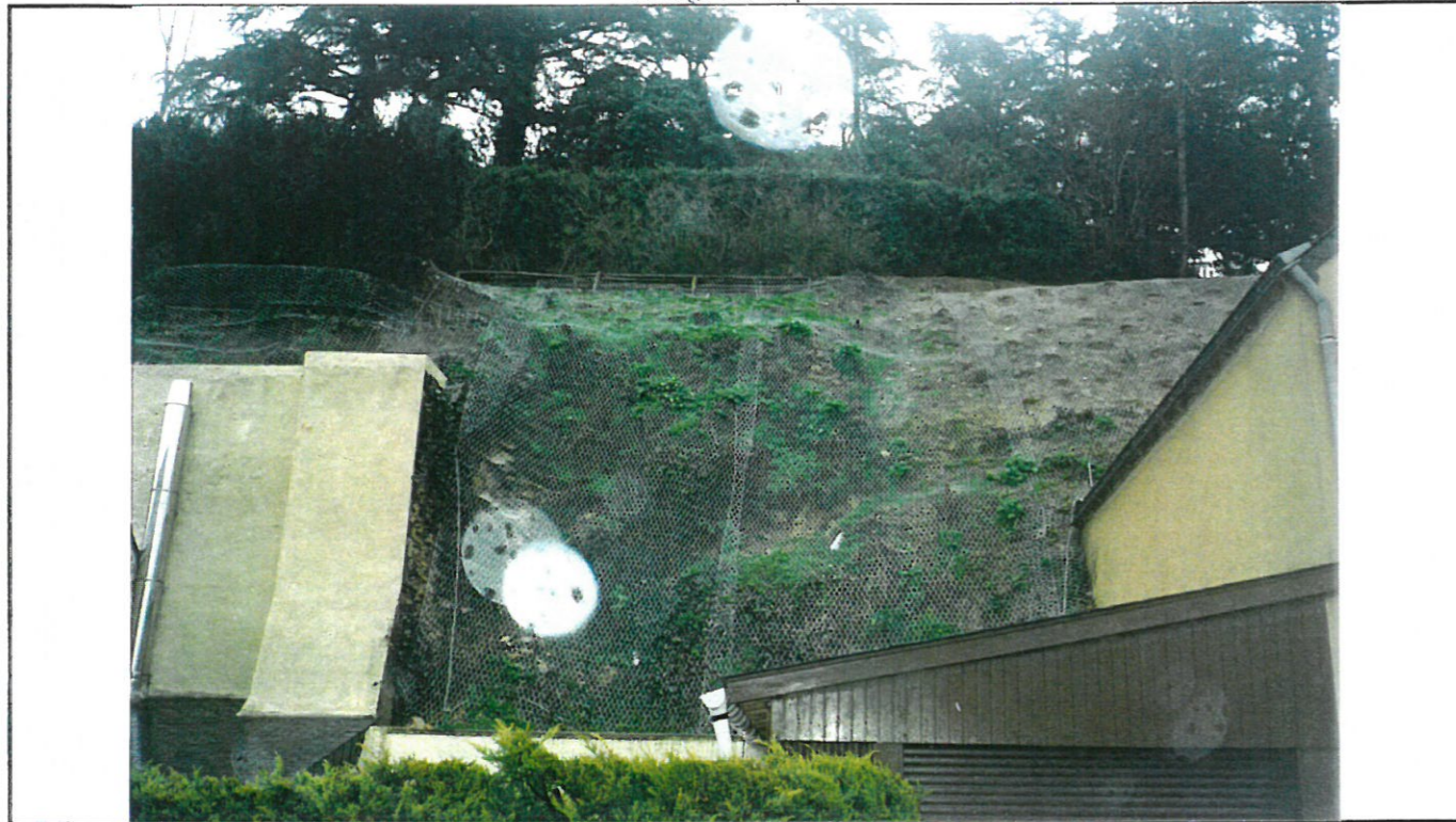
N° 37 de la rue Emile Zola avec le grillage plaqué sur la falaise
