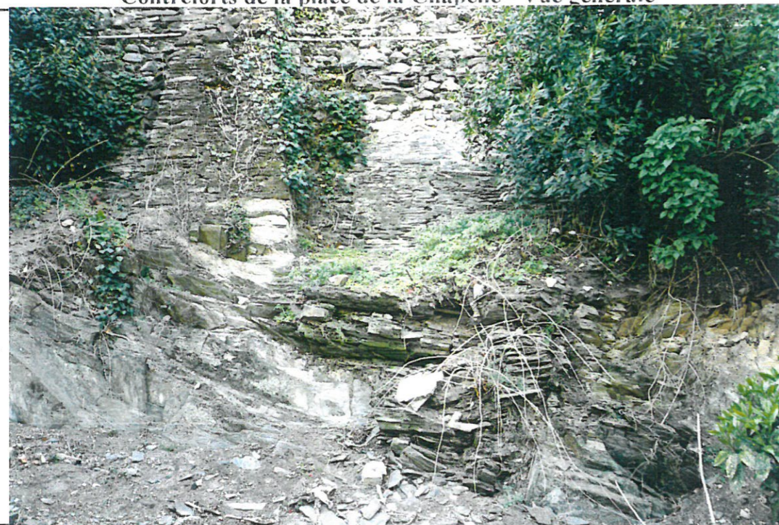
Contreforts de la place de la Chapelle - Les schistes sur lesquels reposent les contreforts se délitent de façon très importante Planche photographique 9
