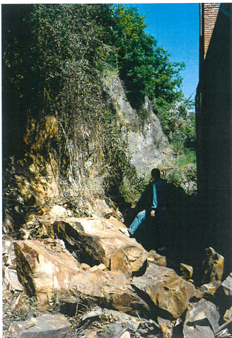
Rue de Maingué - Effondrement au niveau du n° 17 (M. LEGALL) Planche photographique 18
