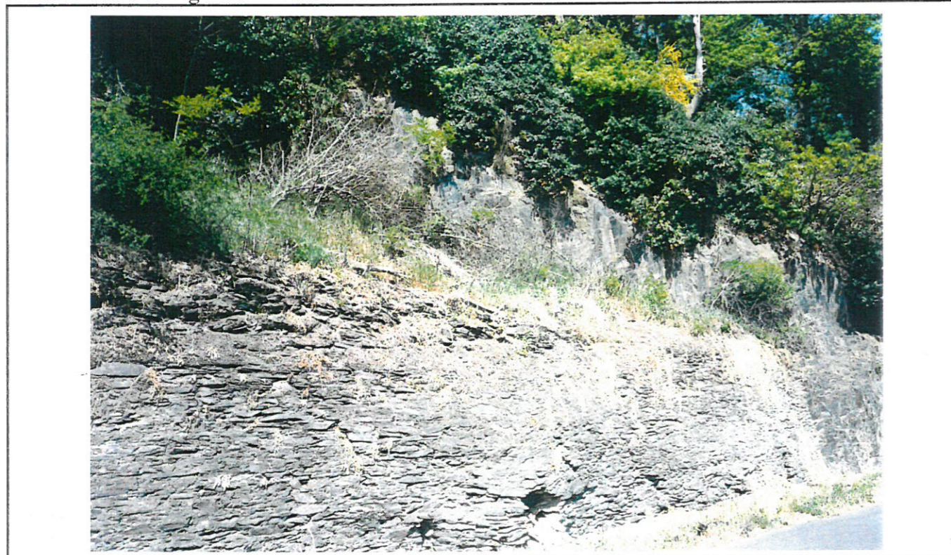
Rue de Maingué - Près du virage, la falaise surplombe à nouveau la rue Le mur est en voie d'effondrement Planche photographique 14
