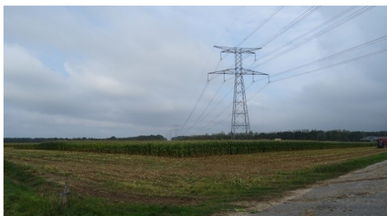
Ligne haute tension
