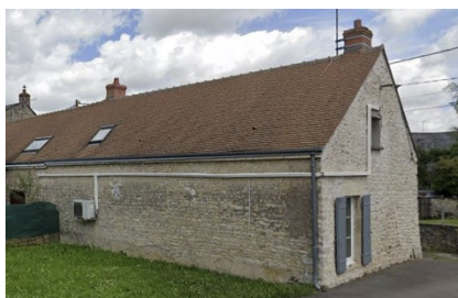
Exemple de réseau de climatisation mal intégré en façade.
