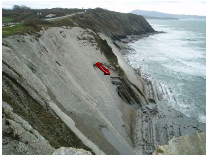
Illustration 37 - Glissement "banc sur banc" sur la Corniche Basque à Urrugne (© Observatoire de la Côte Aquitaine, 18/01/2016)
