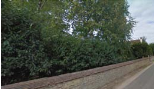
LINEAIRE A : Mur en pierre en bordure de route : 33 rue du Val d'Amour
