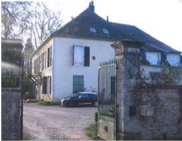
ELEMENT BATI N°6 : Demeure, parc, mur et portail : rue du Val d'Amour
