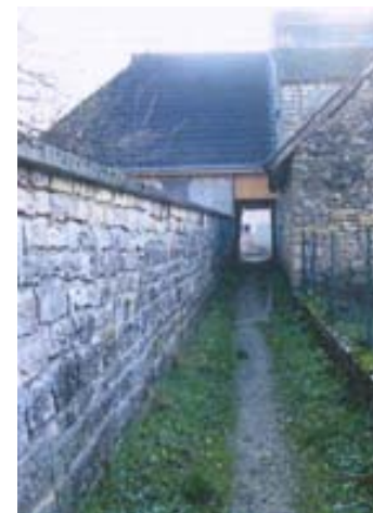
ELEMENT BATI N°26 : Passage vers jardin et mur de l'ancien couvent donnant sur la rue du Coin du Four LINEAIRE D : Passages vers jardins et murs de l'ancien couvent donnant sur la rue du Coin du four
