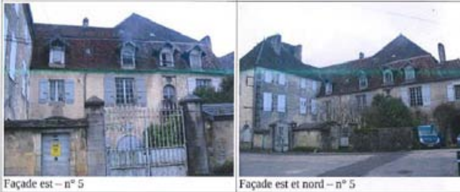
ELEMENT BATI N°20 : Demeure façade (EST, Nord, Ouest) : rue du bas de la Fin/quartier du Port
