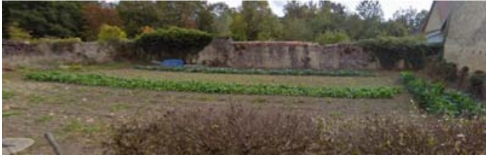
LINEAIRE C : Mur en pierre du parc du château : rue du Val d'Amour
