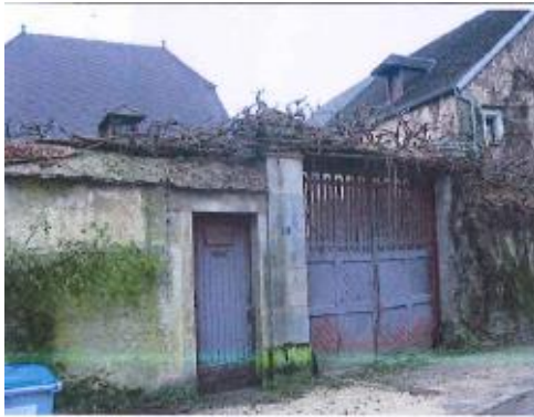
ELEMENT BATI N°22 : Portail et mur côté sud : rue du bas de la Fin/quartier du Port
