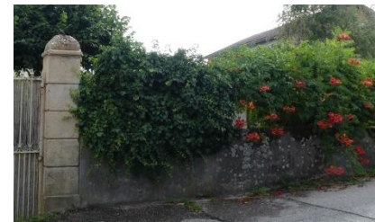
Végétation arbustive débordante du mur - Izeaux
