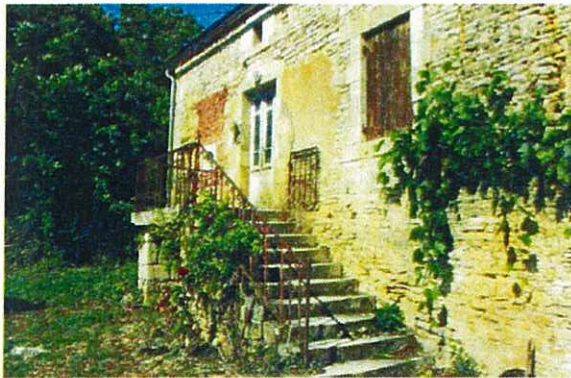
Bâti à l'abandon à l'Est
