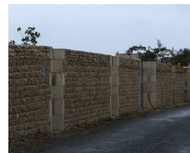
Multiplication des percements qui font perdre l'unité du mur ancien
