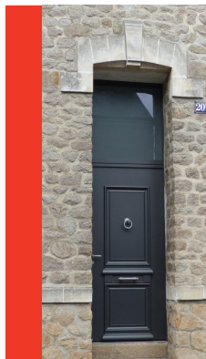
Porte non adaptée à la baie d'origine (problème de proportions)
