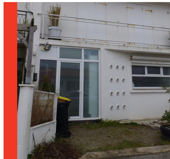
Porche sous balcon fermé par un vitrage, qui modifie la composition de la façade et son épaisseur
