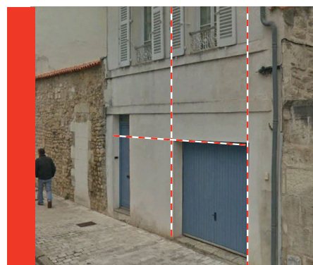
Linteau trop bas et percement aléatoire par rapport aux baies du 1 er étage
