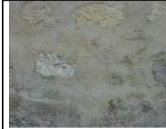
3 Détail d'un enduit à "pierres vues" ou à fleur de parement irrégulier.
